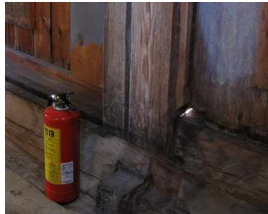
Detalj fra østvegg. Legg merke til utetthet i veggen.
