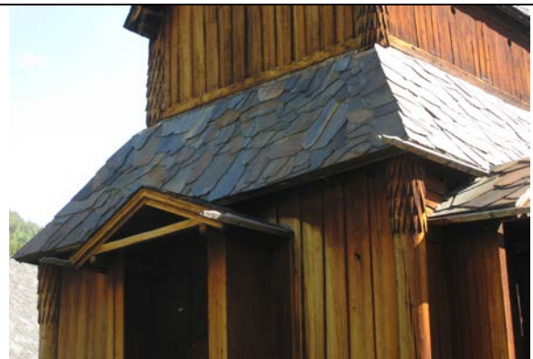
Vestvegg . Takrenner kun mot sør.
