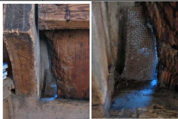
Til høyre for denne benken (foto til venstre) er hull tettet med plastnetting. Dette tar ikke støvet som kommer inn, men hindrer småkryp og til en viss grad insekter. En god ide som ville vært enda bedre om nettingen var bedre tilpasset.
