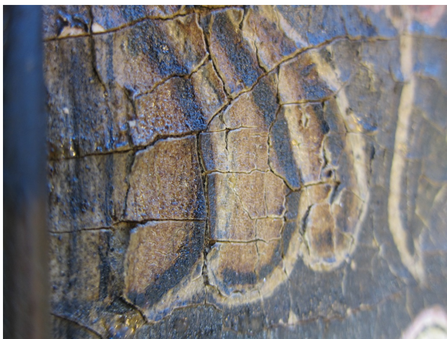
Bilde 10: Oppskallinger i malingslaget.
