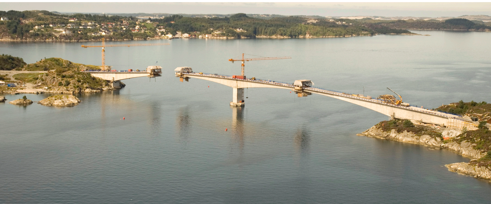
Omfattande brubygging representerer utvikling og omvelting i fylket med overgang frå ferdsl til sjøs og til ferdsl til lands. Her frå øyriket Austevoll. Foto: Inge Døskeland
