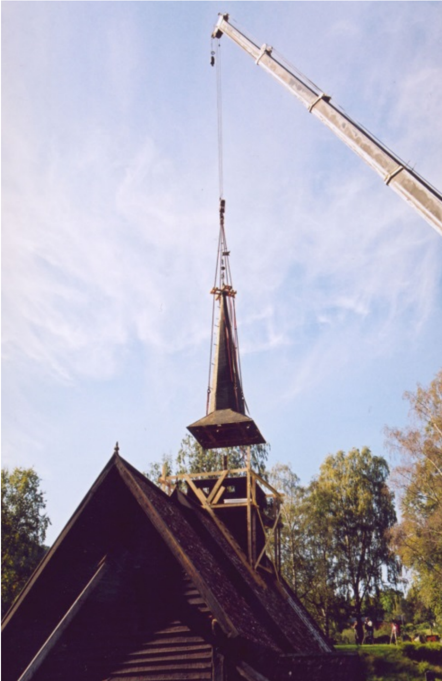
Lyfta av: Tårnet på takryttaren vart lyft med på bakken før istandsetting. Foto: Berge Hjørungnes, Riksantikvarens arkiv.
