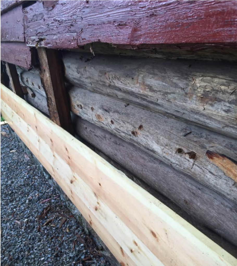
Røteskade: Vestsida av våpenhuset var sterkt røteskadd, med laft på innsida. Foto: Arild Bjarkø, Riksantikvaren
