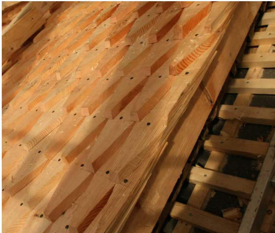
Tekking: Taket på kyrkja fekk ny spon. Foto: Asgeir Spange Brekke/Riksantikvarens arkiv.
