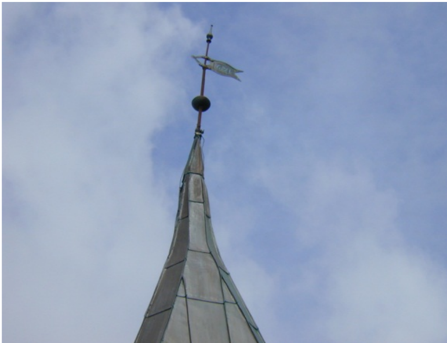
Grip: Kyrkja pregast av naturen sine krefter. Spiret vart bøygd etter ein orkan i 1992. Takstein var sterkt forvitra og gradrenner rustne. Foto: RA arkiv
