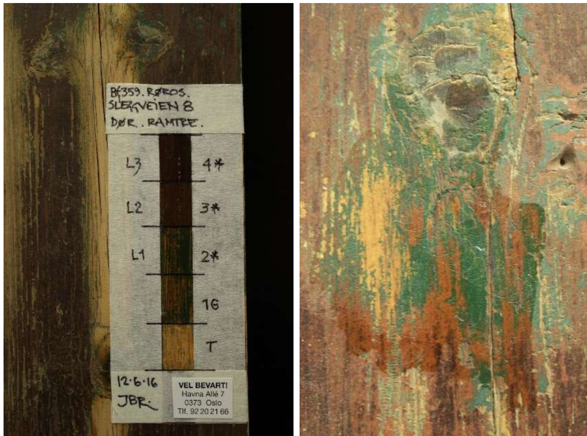
Figur 19. Røros. Sleggveien 8. Fargelagsavdekking på opprinnelig hoveddør fra ca. 1870 til venstre. Før restaurering til venstre. Overflaten er slipt under restaurering på Antikvarisk verksted til høyre. Malinglagene er regenerert av undertegnede for å kunne kode fargene. Foto: J. Brønne. 2016.
