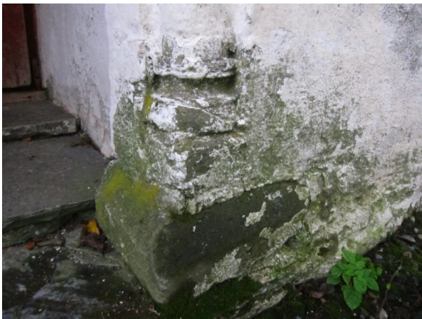
Figur 6: Detalj av vestportalen. Nedre del av portalen er tilgrodd med grønske. Foto: NIKU 2016
