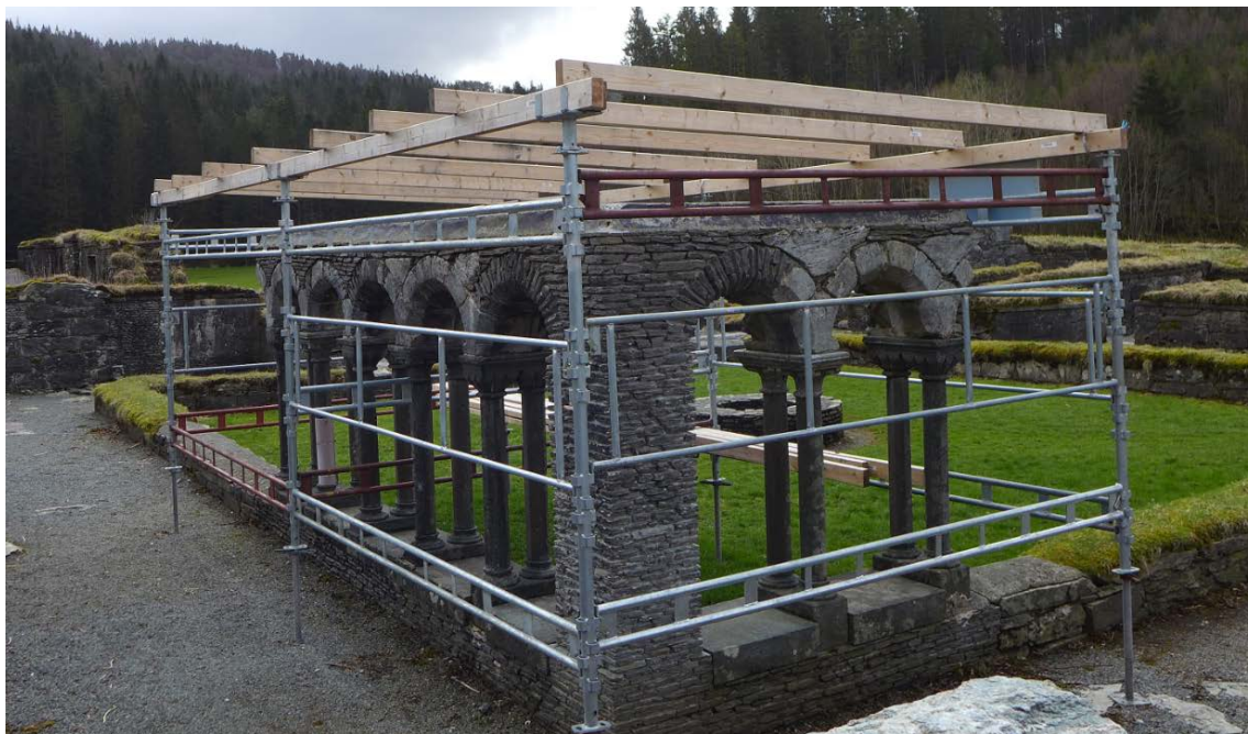
Figur 10. Et vernebygg ble montert over arkaderekken for å gi beskyttelse under arbeidene (Foto: Byantikvaren 2015).
