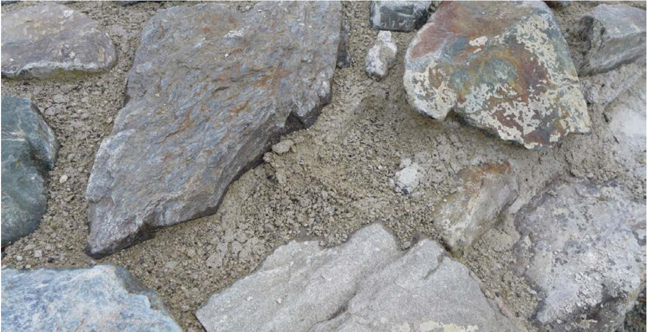
Figur 3. Kalkmørtel på murkronen i oppløsning (Foto: Byantikvaren 2016).
