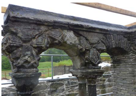
Figur 12. Før tiltak. Detaljbilde av buene fotografert mot vest (Foto: Byantikvaren 2015).
