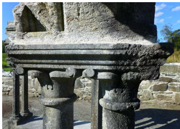
Figur 16. Nyinnsatte kalkfuger mellom kapitel og anfangstein (Foto: Byantikvaren 2015).
