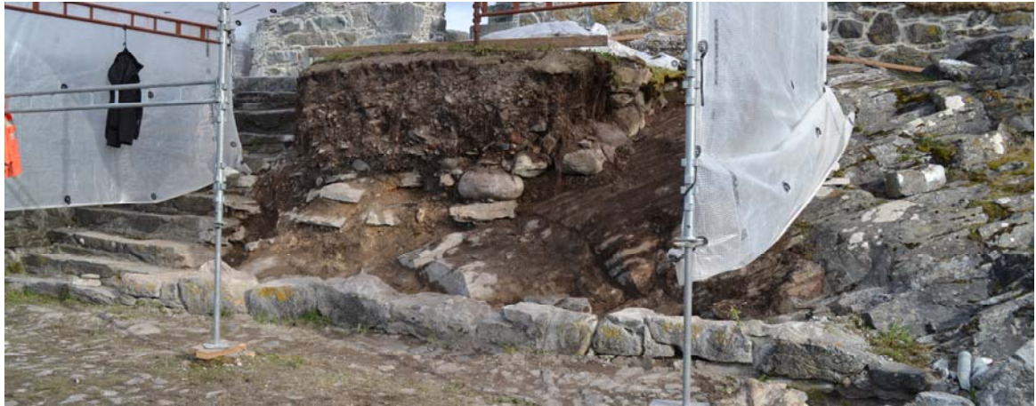
20061140_064 Terrasse ferdig demontert. Til venstre mot trapp sees gul/brun kalkgrus etter gamle rivningsmasser.
