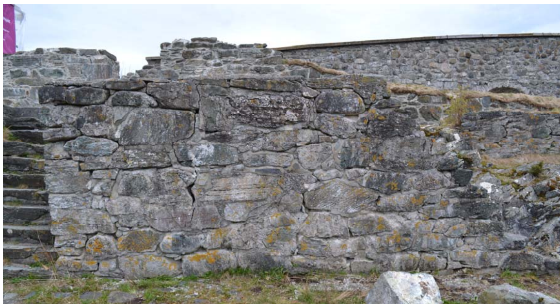
20061140_036 Terrasse før demontering. Murverket var deformert og oppsprukket. Toppdekket på muren besto av en tynn betongkake som var hullet og oppsprukket.
