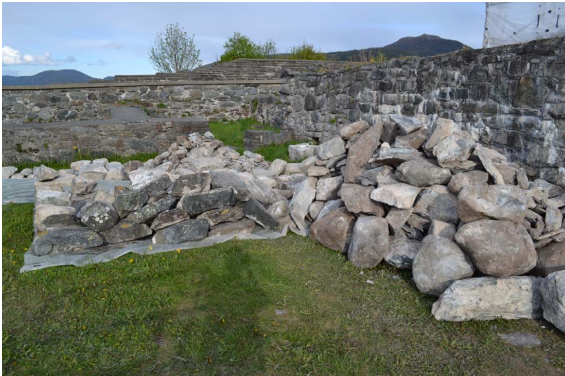
20061140_060 vestre del av terrasse demontert og lagret i borggård. Fasadestein til venstre på bildet og murkjerne til høyre på bildet. Steinene er renset for sementmørtelrester og betong
