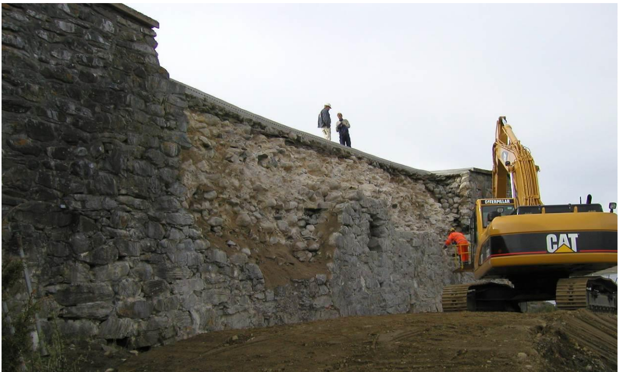
Sen- middelaldersk murkjerne på Steinvikholm med gulbrun kalkmørtel og stein lagt i kjernen.
