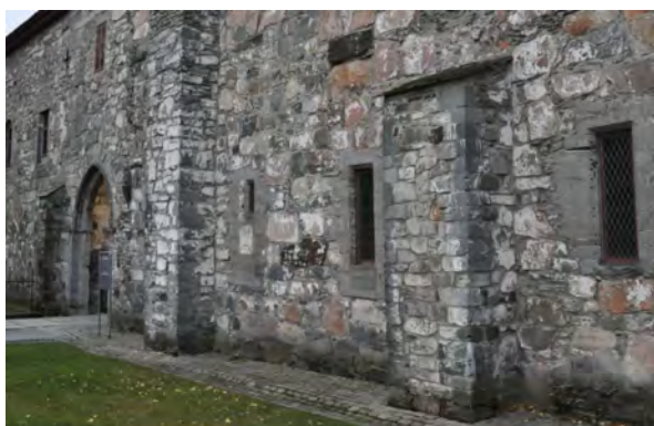
Figur 18. Eksempler på utvendige strebe-pilarer fra vestfløyen i Erkebisppegården i Trondhjem. Pilarene er en del av støttesystemet for hvelving av rom (Foto: Byantikvaren 2015).
