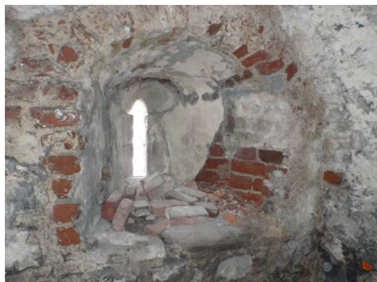
Fig. 24. Før tiltak: Innsiden av vindussmyget. Store deler av teglforingen var ødelagt som følge av fukt og frostsprengning (foto: Byantikvaren 2015).
