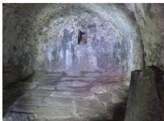
Fig. 25. Luftgjennomstrømning fra smyget til en ventil i bakveggen i ruinrommet fører til et relativt tørt inneklime i ruinrommene (foto: Byantikvaren 2015).
