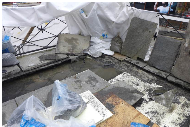
Fig. 18. For å lede vann bort fra kanten av terrassen ble dekket omkring pilaren forsøkt utbedret (foto: Byantikvaren 2014).
