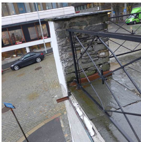
Fig. 17. Vann fra området omkring pilaren på terrassen har ført til skader i kalkpussen (foto: Byantikvaren 2014).
