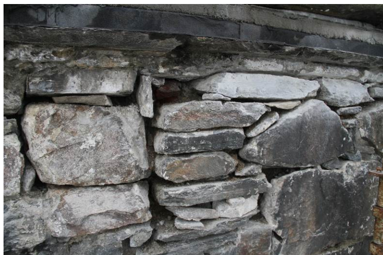
Fig. 5. KC-fugene i murlivet ble krasset ut og stod til uttørking under vernebygg, gjennom vinteren 2014 (foto: Byantikvaren 2014).
