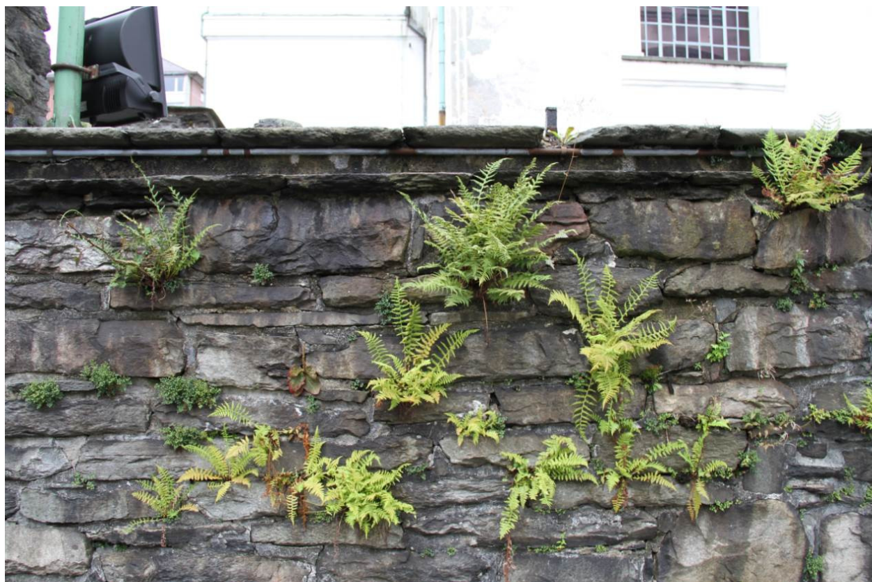
Fig. 4. Før tiltak: Murlivet mot sør med omfattende begroing, løs stein og sprukne murfuger (foto: Byantikvaren 2012).
