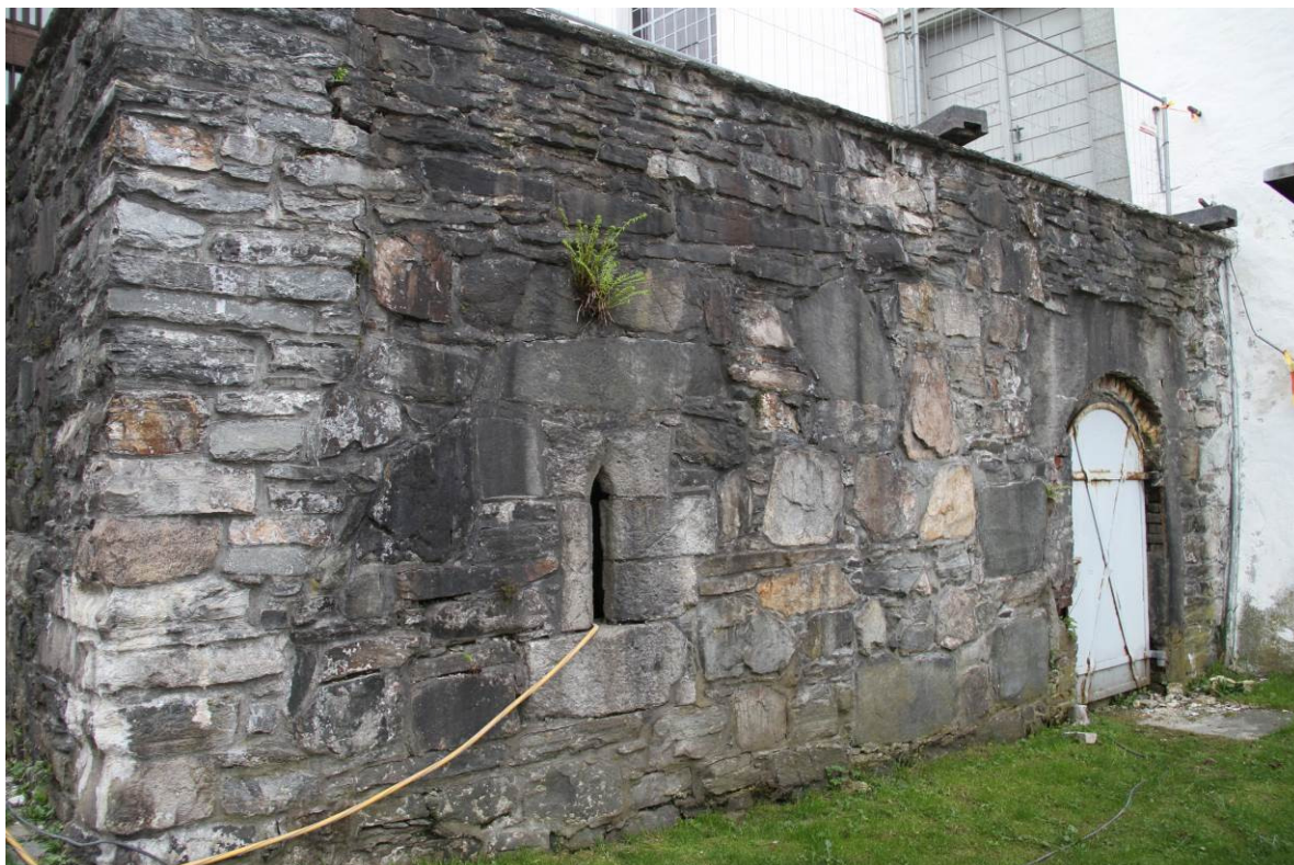
Fig. 11. En stor del av østveggen består av gotisk murverk fra middelalderen. Bildet viser veggen før tiltakene da murfugene var spekket med KC-mørtel (foto: Byantikvaren 2012).
