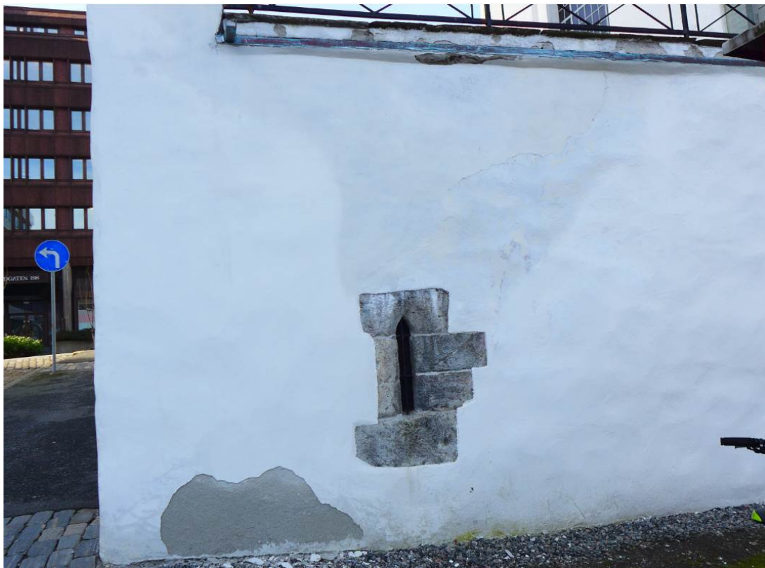
Fig. 19. Skader og skjolder i pusslaget vitner om at det fremdeles er vanntilslig fra terrassedekket (foto: Byantikvaren 2016).
