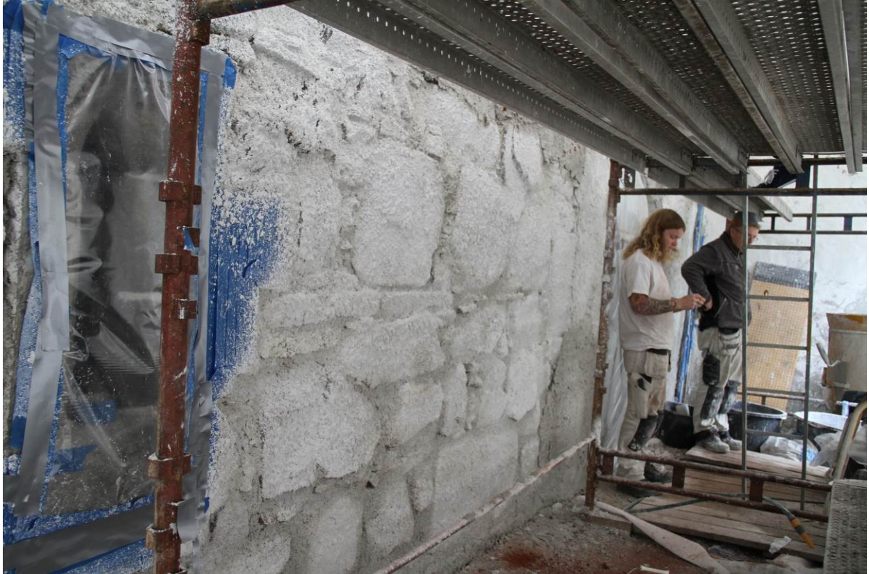
Fig. 14. Klebersteinsinnfatningen i vindussmyget ble beskyttet med et plastdekke da pusslaget ble sprøytet på nedre del av østveggen (foto: Byantikvaren 2014).
