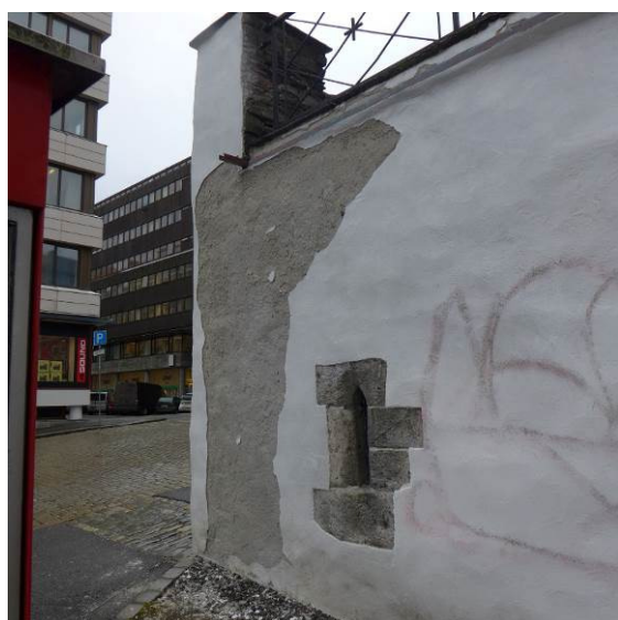
Fig. 16. Omfattende avskallinger i kalkpussen under dryppnesen (foto: Byantikvaren 2015).
