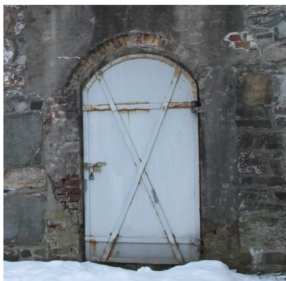
Fig. 20. Før tiltak. Døren inn til ruinrommene under terrassen (foto: Byantikvaren 2010).
