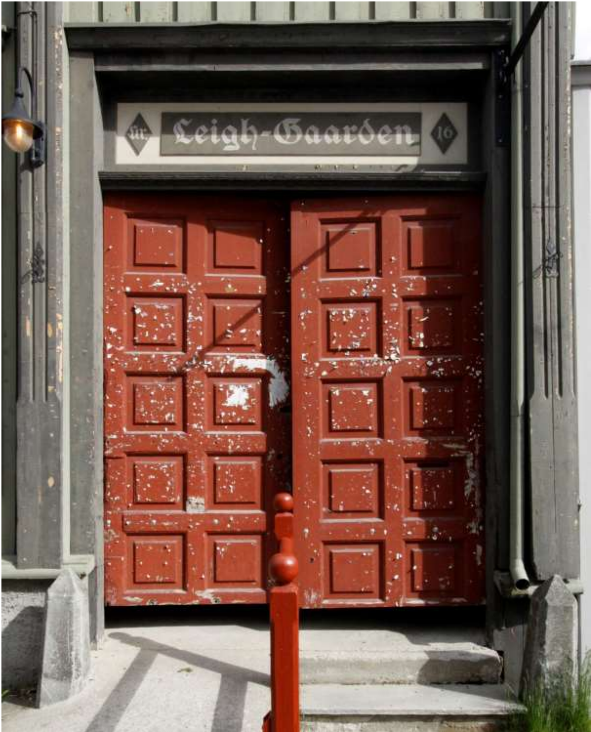
Figur 14. Røros, Engzeliusgården. Porten. Nedre ramtrær er kraftig forhugget i forbindelse med bygging av inngangs/rullestolsrampe til tidligere butikkinngang. Skiltet på supraporten er fra 1949-50. De hvite flekkene er rester av plakater og oppslag. Foto: J. Brønne. 2012.
