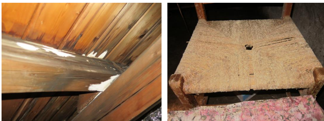
Figur 1. Ved å skille mellom skader som er klimauavhengige (foto til venstre, råteskade grunnet taklekkasje) og de som er klimaavhengige (foto til høyre, muggsoppskade på inventar etter en lang regnværsperiode), kan man spesifisere hvilke problemstillinger som det er aktuelt å følge opp med en tilpasset miljøovervåkning.
