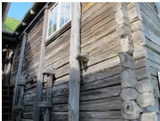
Figur 2. Det er et mønster i skadebildet som ser ut til å kunne stemme med en optimal kombinasjon av soloppvarming og oppfukning.
