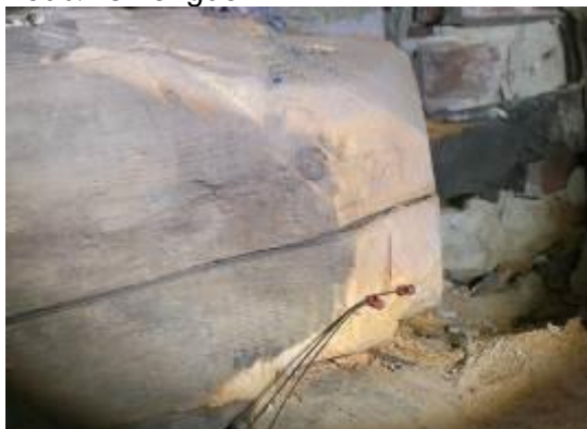
Figur 1. Fuktensensorer monterte i bjelkeende. Sensorene består av korte skruer kablet til sender for dataoverføring.
