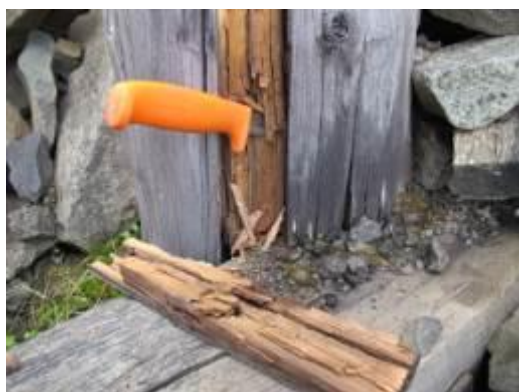
Figur 2. råtekontroll i stolper på Svalbard.
