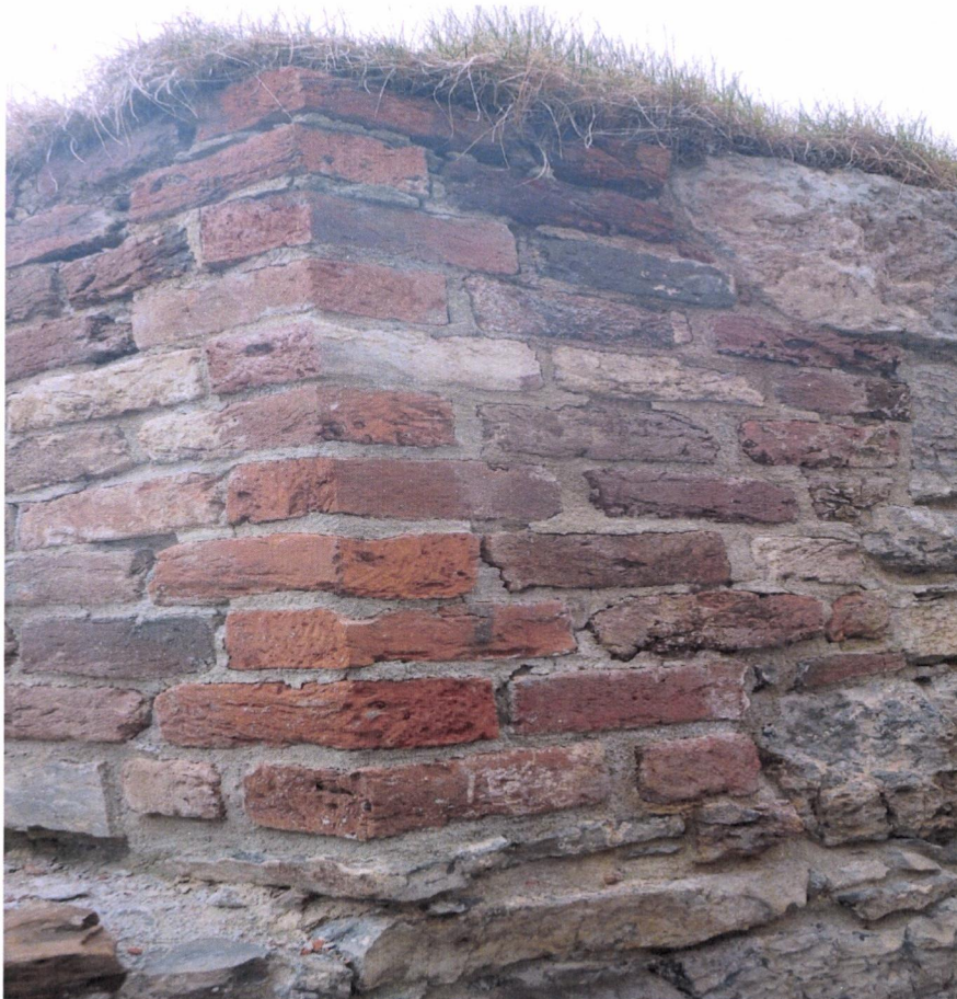
Vindusnisje i sydfløyen, Domkirkeodden. Denne ble konservert i 2012, med toppdekke i Dantonitt 2013. Avrenning fra toppdekket har i etterkant skapt frostsprengning i murverket.
