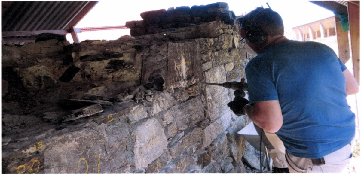
Den gjenoppmurte østsvangen og toppdekket fra 60-tallet har begge en sementdybde på nærmere 60 cm. Opprinnelig høyde på toppdekket før meisling sees i bakgrunnen.
