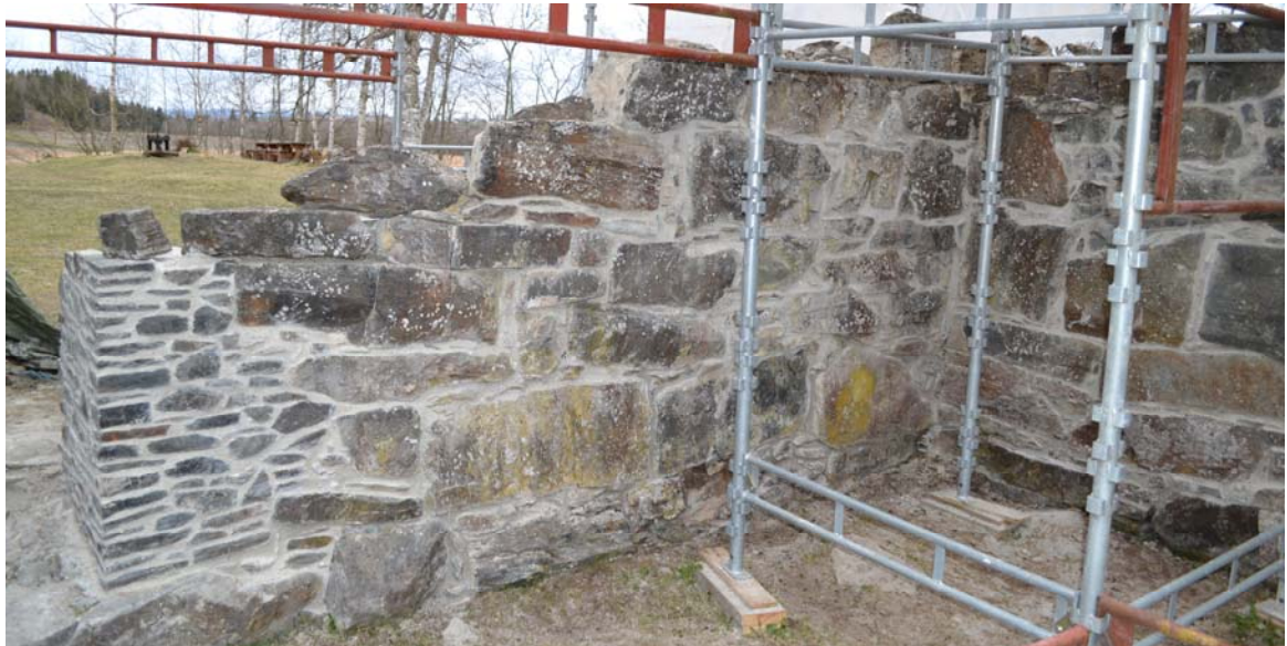
20050627_020 Nordre tverrskip's vestre og nordre vegg innvendig ferdig spekket. Mot døråpning kan benyttet småsteinsrekonstruering sees.
