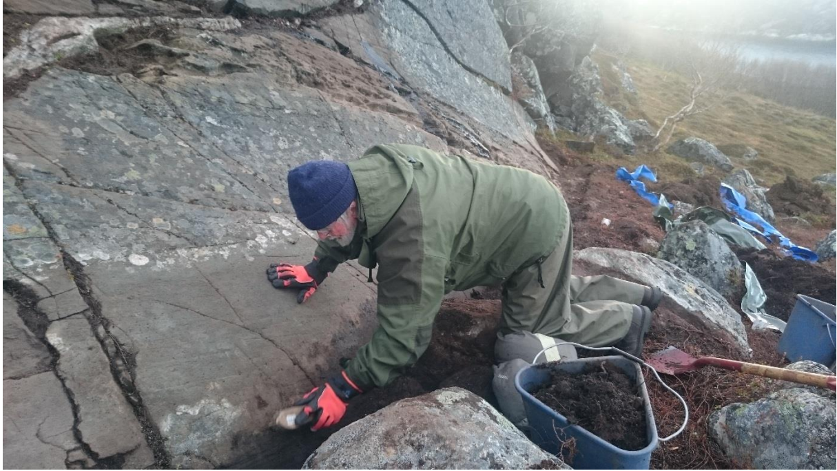
Figur 5 Kosting for å fjerne mose/lav på bergveggen. Sett mot SØ. 21.10.2015
