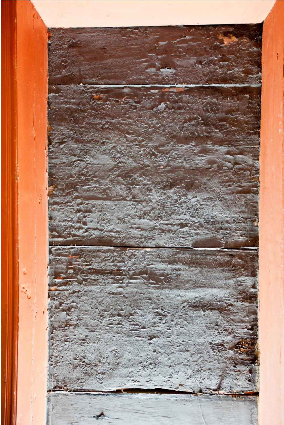
FLESBERG Tilstanden av malt dekor i himlingen som viser oppskallingene og løs maling i sidelysopptak.
