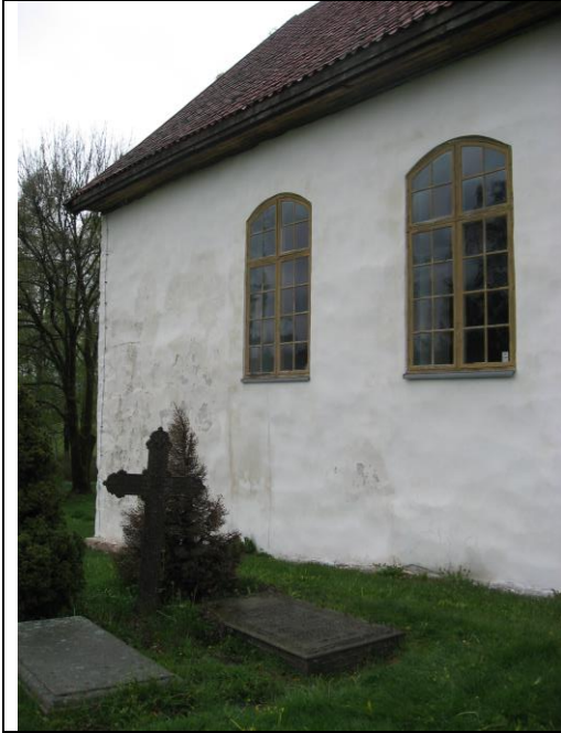
Bilde 7. Sørfasade mangler takrenner og nedløpsør.
