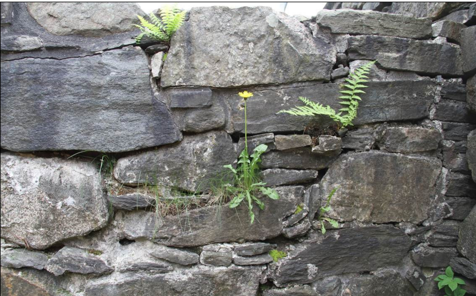
Figur 34: Sørmuren i rom 2. Det ytre sementskallet i fugene har løsnet og den oppløste mørtelen ligger eksponert og gir gode vekstforhold. Lengst til venstre er det et tydelig rekonstruert parti som strekker seg inn i den tørrmurte festningsmuren mot vest (Foto: Byantikvaren, Bergen kommune 2013).
