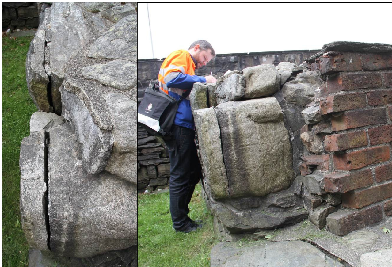
Figur 18: Sørmurens ytterliv i rom 1. Store avskalinger som er i ferd med å løsne (Foto: Bergen kommune, Byantikvaren 2013).
