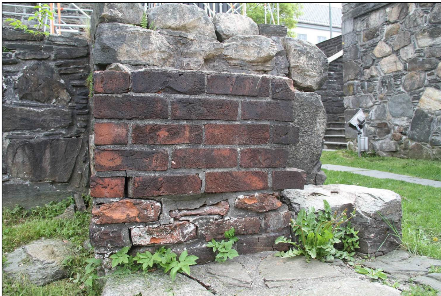
Figur 22: Østre vange i portalen i sørmuren, rom 1. Den indre delen består av teglstein, mens det i ytterlivet står igjen en avfaset kleberstein med anslag. Sementmørtelen i fugene har sprukket opp og er delvis løse. Det er vegetasjon i fugene (Foto: Byantikvaren, Bergen kommune 2013).
