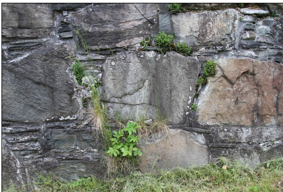
Figur 28: Begroing i åpne hull i fugene fører til ytterlige skader av murverket (Foto: Byantikvaren, Bergen kommune 2013).
