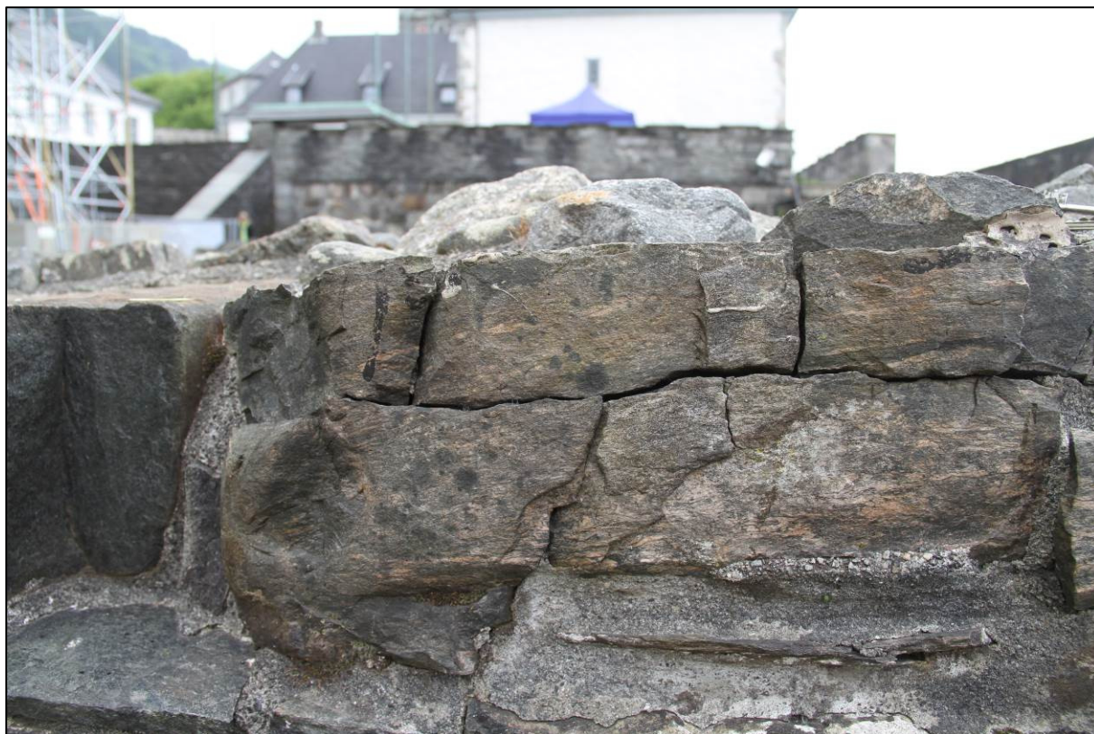
Figur 44: Eksempel på oppsprukken bygningsstein i sørmuren i rom 3 (Foto: Byantikvaren, Bergen kommune 2013).
