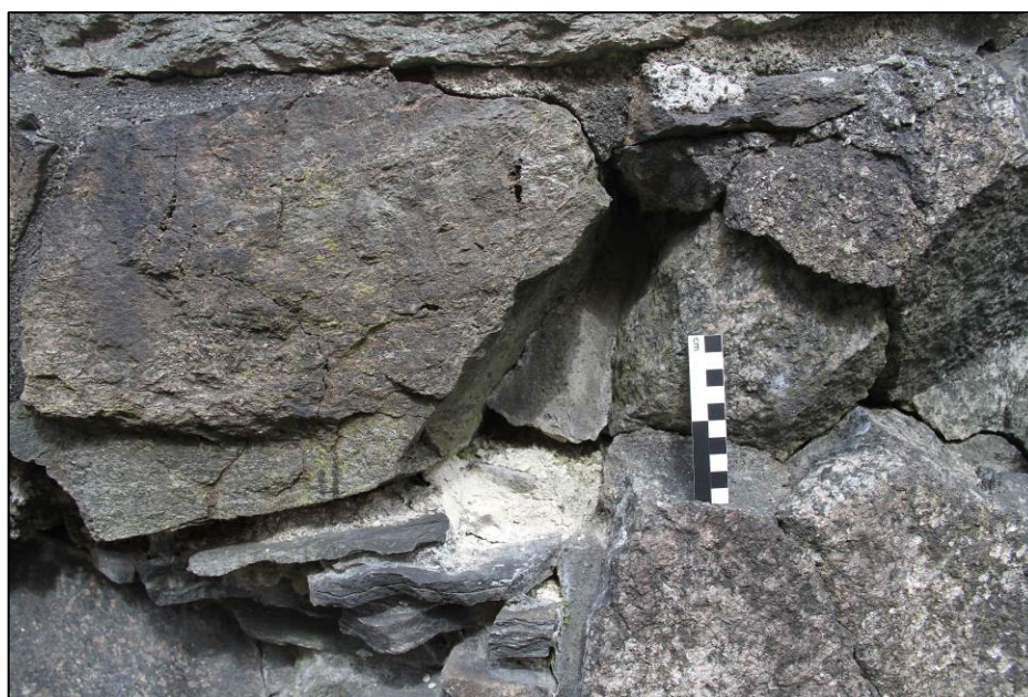
Figur 19: Sørmurens ytterliv i rom 1. Eksempel på oppsprukne sementfuger som delvis har løsnet og falt av. Bakkenfor ligger oppløst mørtel eksponert. Det mangler også pinningsstein i murverket (Foto: Bergen kommune, Byantikvaren 2013).
