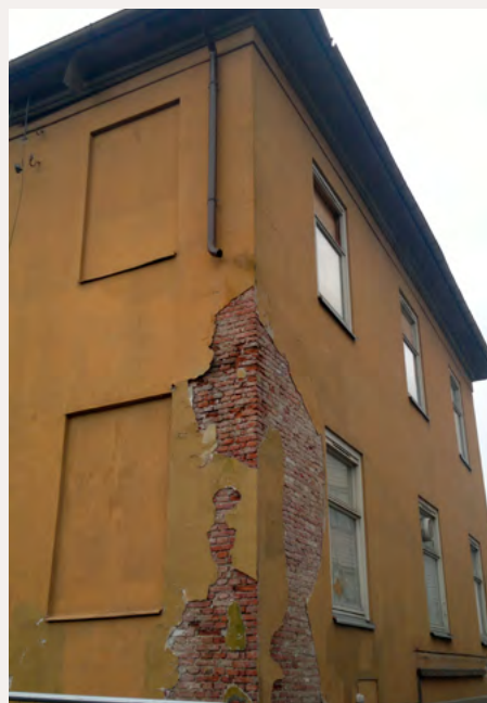
Med mer nedbør blir det ekstra viktig at beslag, takrenner og nedløp fungerer. Foto: Andre Korsaksel © Riksantikvaren
