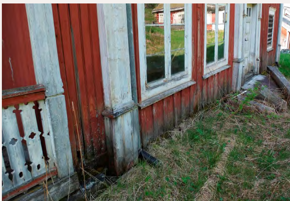
Nedfuktete bygningsdeler må raskt kunne tørke opp igjen. Det er derfor viktig å fjerne vegetasjon som vokser opp langs nedre delen av veggen, og sørge for riktig terrengfall vekk fra bygningen.
