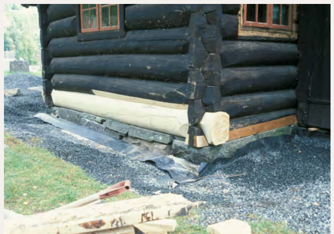
Istandsetting av råteskadet laftekonstruksjon med tradisjonelle metoder og materialer. Her er den råteskadete bunnstokken skirket ut med en ny.
