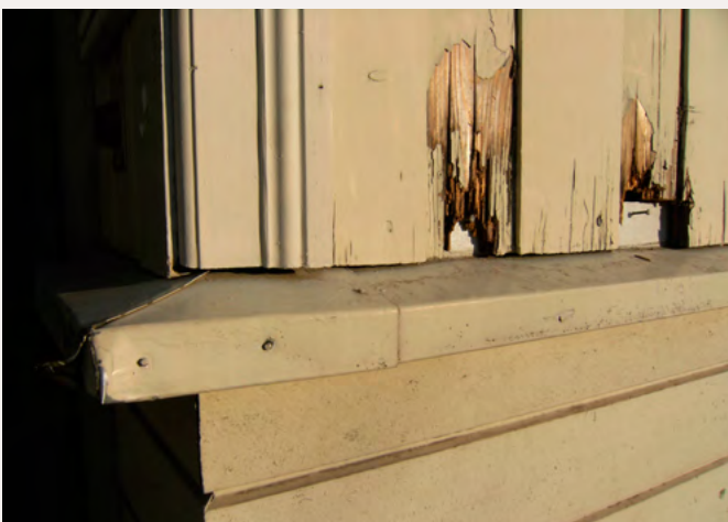
De aller fleste nye materialer og bygningsdeler har langt fra så god kvalitet som de eldre. Panelet på bildet er fra hurtigvoksende trevirke og råtnet noen år etter at det erstattet det gamle. Vannbordet må beslås fordi det ikke tåler å stå ute uten beskyttelse.
