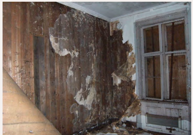
Alvorlig hussopp-skade kan bli resultatet av tetting og etterisolering. Foto © Riksantikvaren
