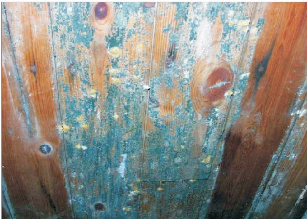
Muggvekst i tak som følge av lekkasjer
