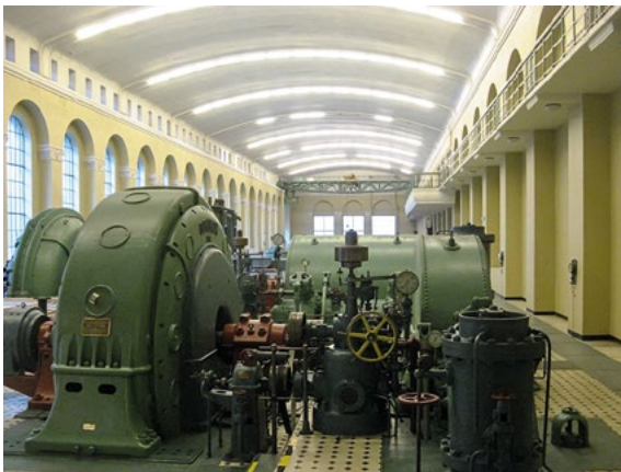
Interiør i Såheim kraftstasjon, med de bevarte aggregatene i maskinhallen. Foto: Trond Taugbøl.
