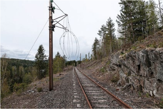
Kjøreledningsanlegget på Tinnosbanen er utsatt for tyveri av koppertråd. Foto: Per Berntsen.
