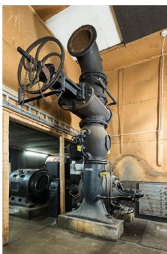
AEG-pumpa i Pumpehuset. Foto: Per Berntsen.
