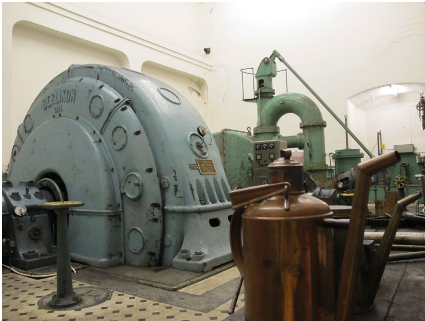
Fig. 35 Såheim kraftstasjon, kraftaggregat i fjell. Foto: Trond Taugbøl
