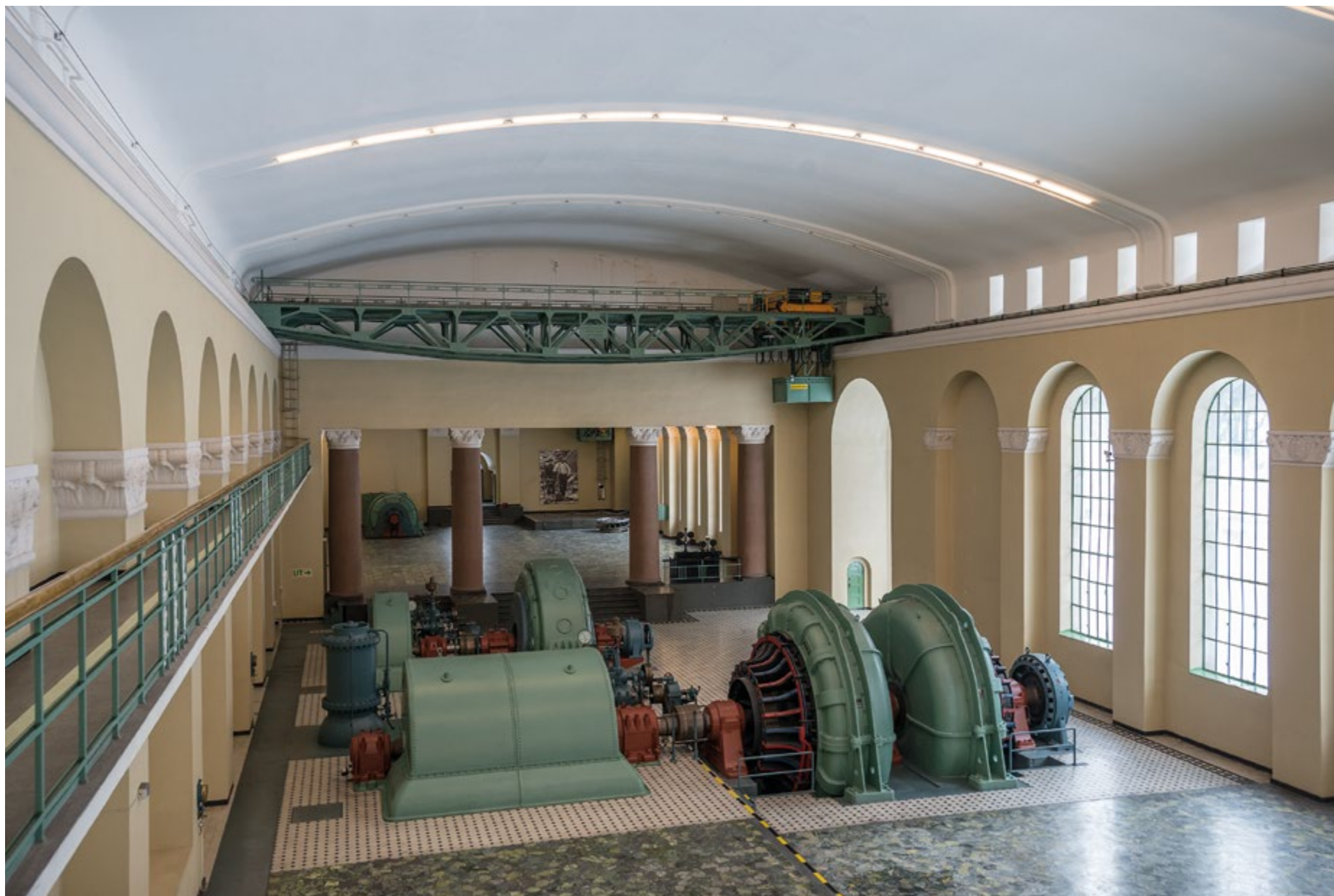
Fig. 34 Såheim kraftstasjon. Foto: Per Berntsen
