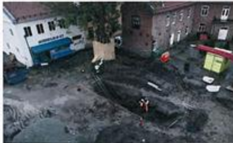
Dannet byggeteile i Munkhaugveita/Presidentveita skal det bygges nye boliger der det har stått hus fra byens tidlige tid, foto: NIKU/NIKU
