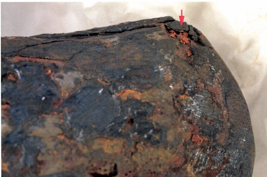
Figur 7 Detaljfoto: Fersk korrosjon, underhjalte.
