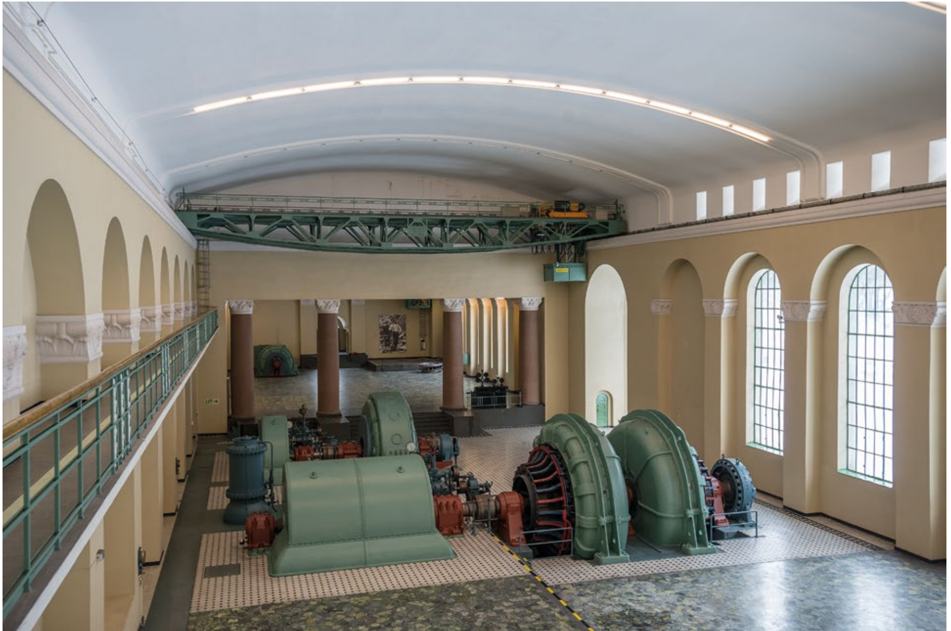
Fig. 34 Såheim Power Plant. Photo: Per Berntsen
