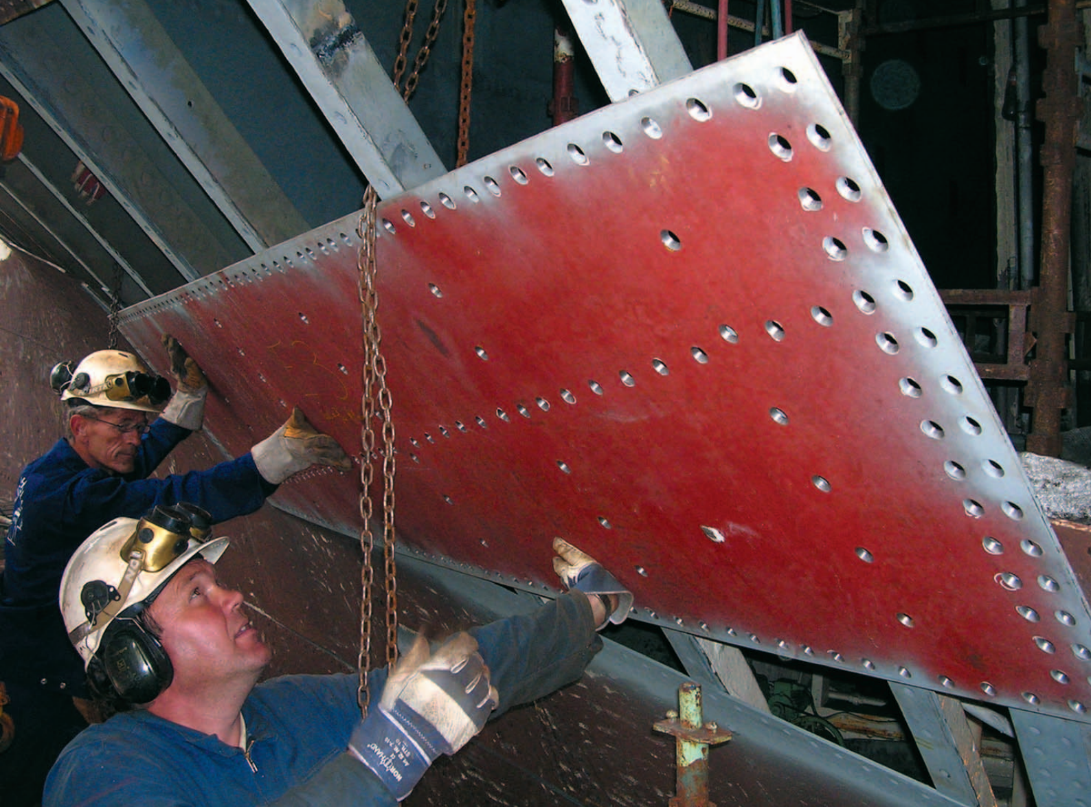
Figur 42: Skifting av svekkede hudplater på eldre klinkede stålskip er en omfattende prosess. Det er Sjøfartsdirektoratet som ut i fra en sikkerhetsvurdering avgjør hvilke plater som skal skiftes. Her gjøres det klart for å klinge på plass en ny stålplate i Fullriggeren Sørlandet . Platen er en nøyaktig kopi av den originale. Ved rehabiliteringen av Sørlandet ved Bredalsholmen Dokk og fartøyvernsenter (2005-2007) ble mer enn 30 av skipets i alt 250 plater, skiftet ut. Foto: Bjørn Nesdal, Bredalsholmen Dokk- og fartøyvernsenter.
