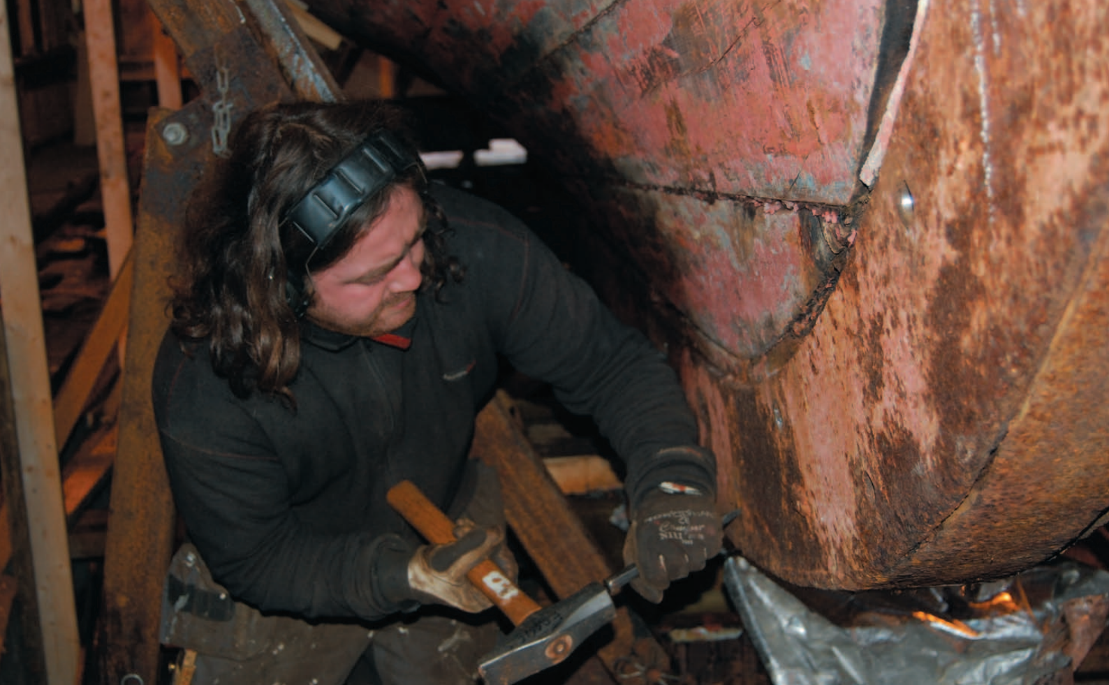
Figur 11: M/B Stangford settes i stand ved Hardanger Fartøyvernssenter, og her er demonteringsarbeidet i gang. Fartøyet er bygget i 1933 på Løfallstrand i Kvinnherad, er 45 fot langt og har vært brukt som skyssbåt i Stongfjorden i Sogn og Fjordane. Stongfjorden var et industristed, og Stangford blir bevart som en del av industrihistorien i Askvoll kommune. Norges Sildesalslag leide inn Stangford i hennes siste fase, og hun opererte da som oppsynsbåt for Fiskeridirektoratet. Foto: Karsten Mæhl, Hardanger fartøyvernssenter
