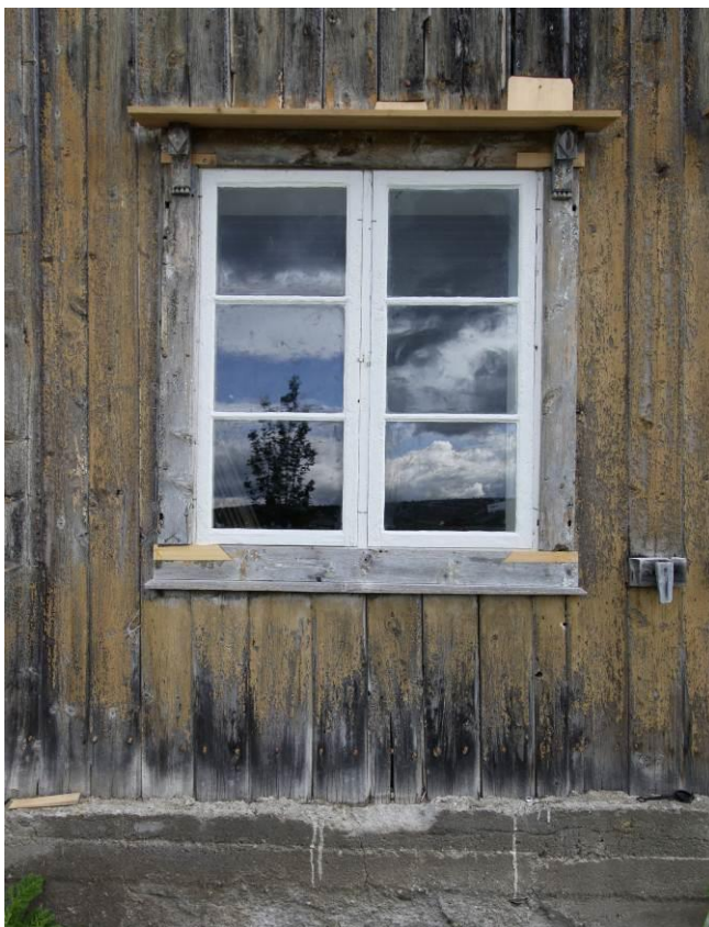
Figur 4. Røros landsogn. Mattisvollen. Vinduene og vindusgeriktene er av en type som var vanlig i Røros bergstad i første halvdel av 1800- åra. Vinduene er de karakteristiske torams Rørosvinduene med tre glass i liggende format i hver ramme. Foto. JB. 2010.
