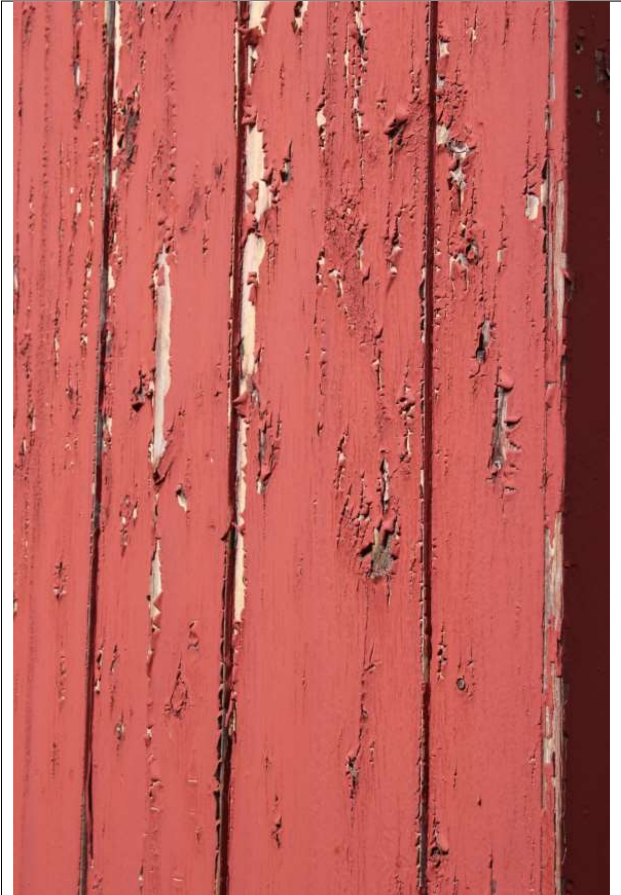
Fig. 2 Fig. 12. Kjergata 51. Gårdsrommet sett mot vest. Østveggen av trappehuset har usedvanlig kraftige malingskader. Denne typen opp- og avskallinger skyldes at denne delen av huset vanligvis ikke er oppvarmet, og den relative fuktigheten er derfor vesentlig høyere enn bak det øvrige panelet på huset. Denne delen av huset ble også modernisert i slutten av 1950- åra. Foto: Brønne. 8.-9. juli 2013.
