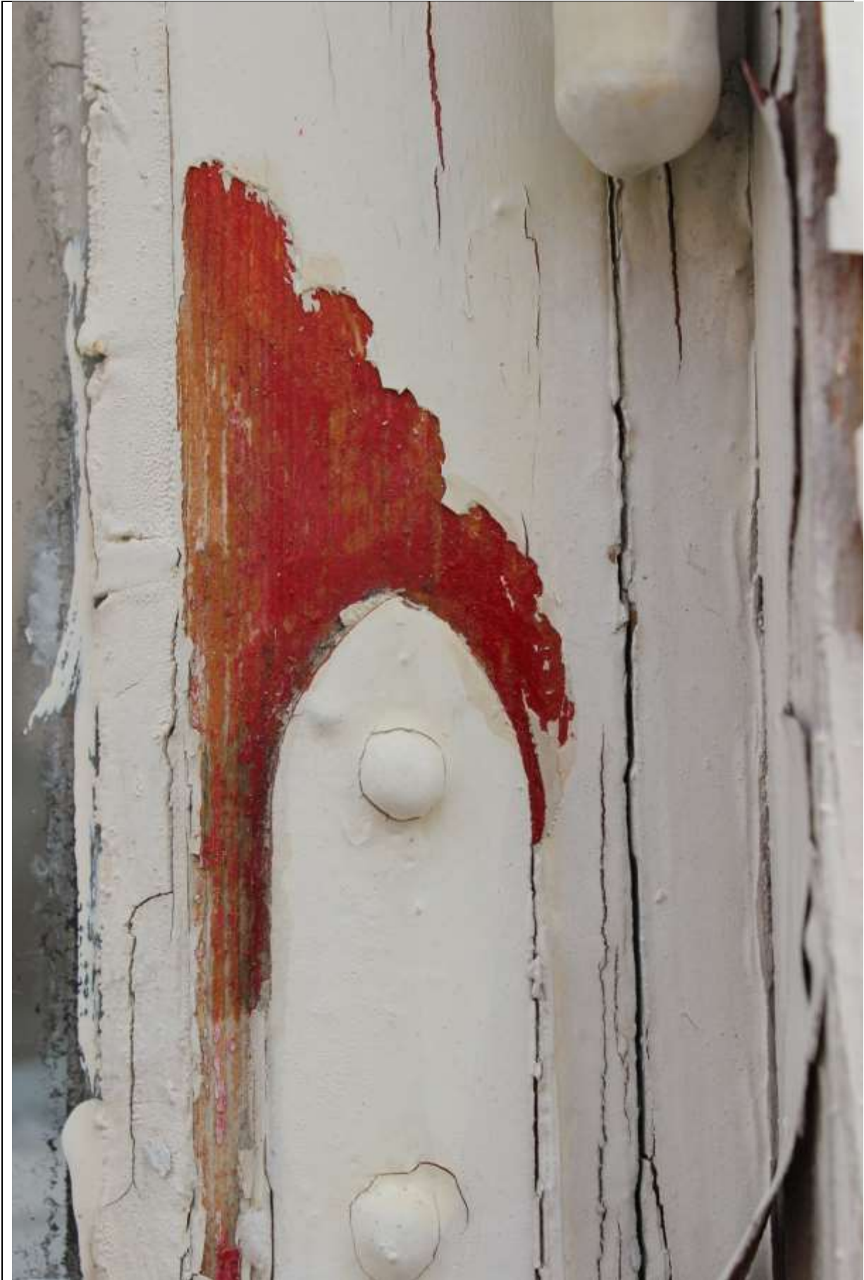
Fig. 10. Kjerkgata 51. Avdekket opprinnelig farge på vindu i 1. etasje. Foto: Brønne. 8.-9. juli 2013.
