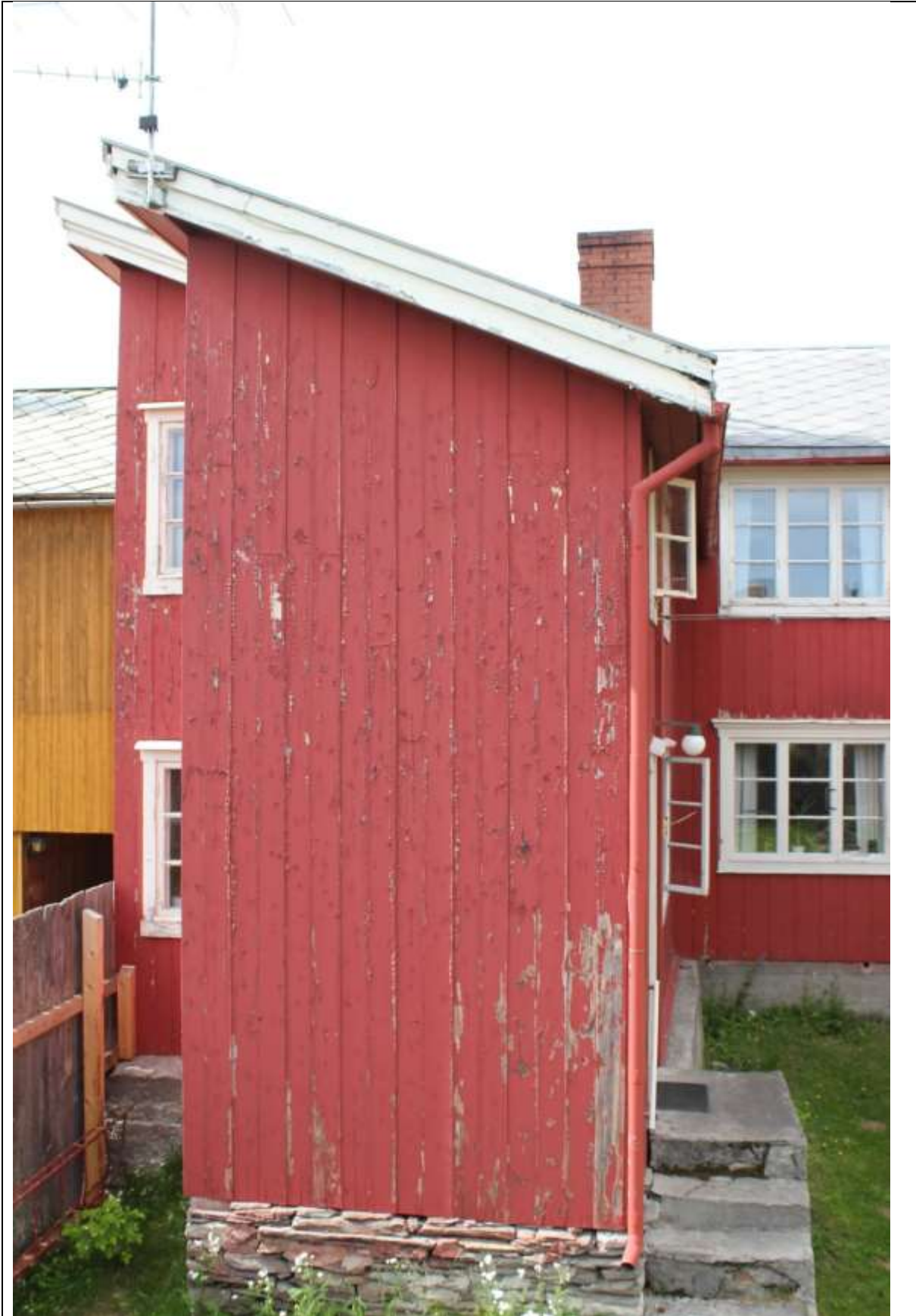
Fig. 12. Kjergata 51. Gårdsrommet sett mot vest. Østveggen av trappehuset har usedvanlig kraftige malingskader. Denne delen av huset ble også modernisert i slutten av 1950- åra. Foto: Brønne. 8.-9. juli 2013.
