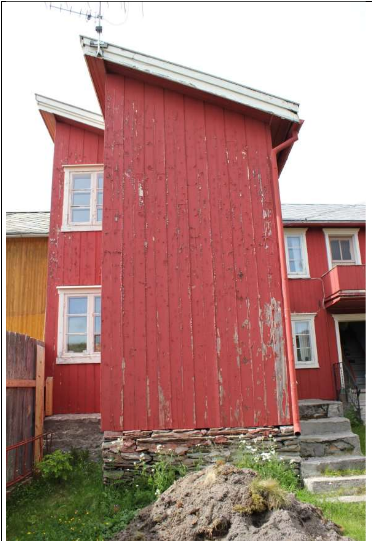
Fig. 13. Kjerkgata 51. Gårdsrommet sett mot vest. Østveggen av trappehuset har usedvanlig kraftige malingskader. Denne delen av huset ble også modernisert i slutten av 1950- åra. Foto: Brønne. 8.-9. juli 2013.
