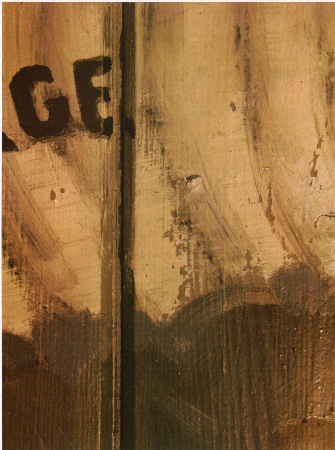
Figur 26. "Amundsenvillaen". Rom 116. Sydvegg, Detalj av opp- og avskallinger i dekoren før sikring med overliming med Japanpapir og Gelatin. Foto. JB. 21.1.2004.
