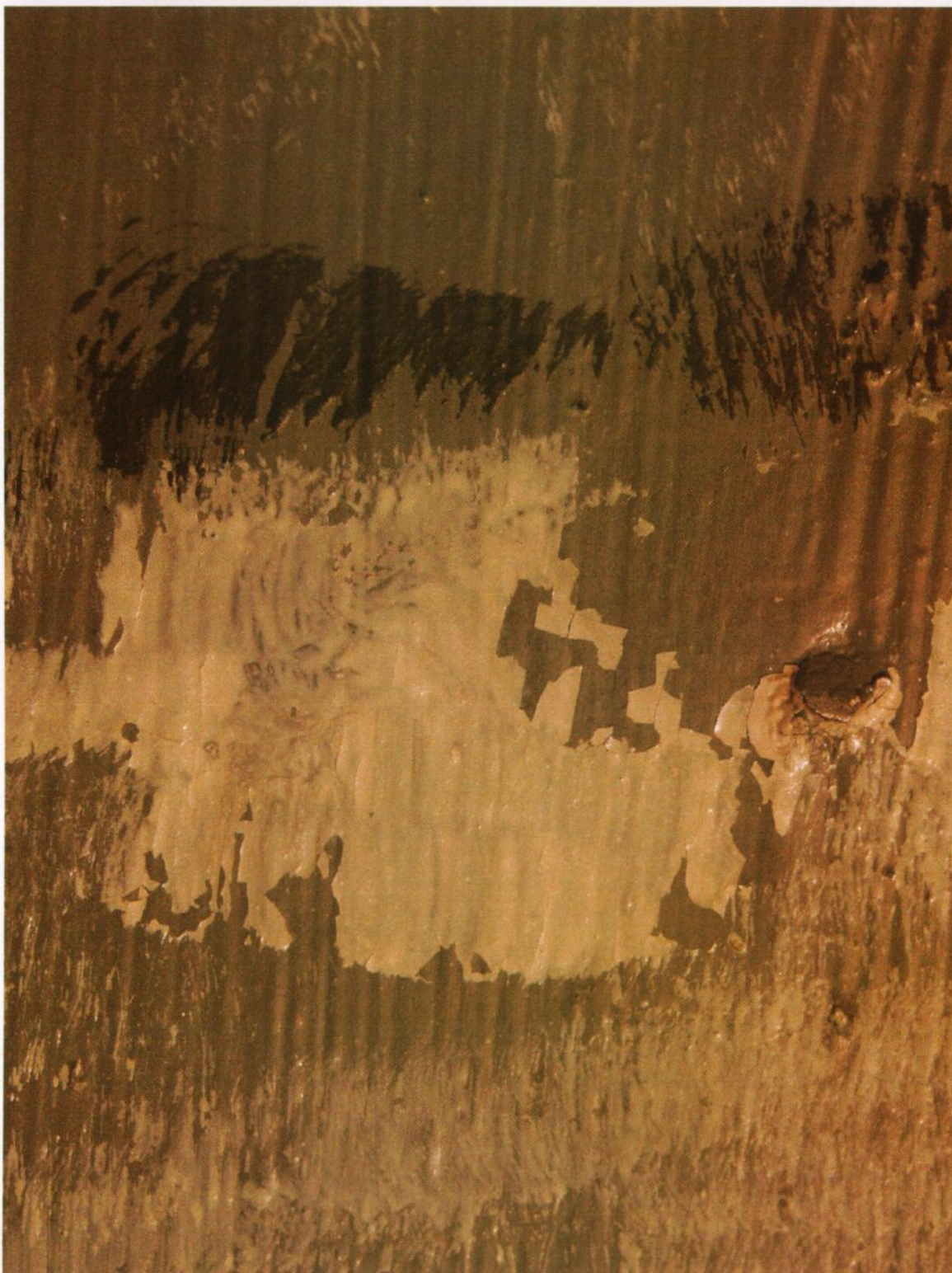
Figur 22. "Amundsenvillaen". Rom 116. Sydvegg, opp- og avskallinger i dekoren i nedre del, under luftskipet Norge. I bildets øvre, høyre del er det store utfall av maling. Foto. JB. 21.1.2004.
