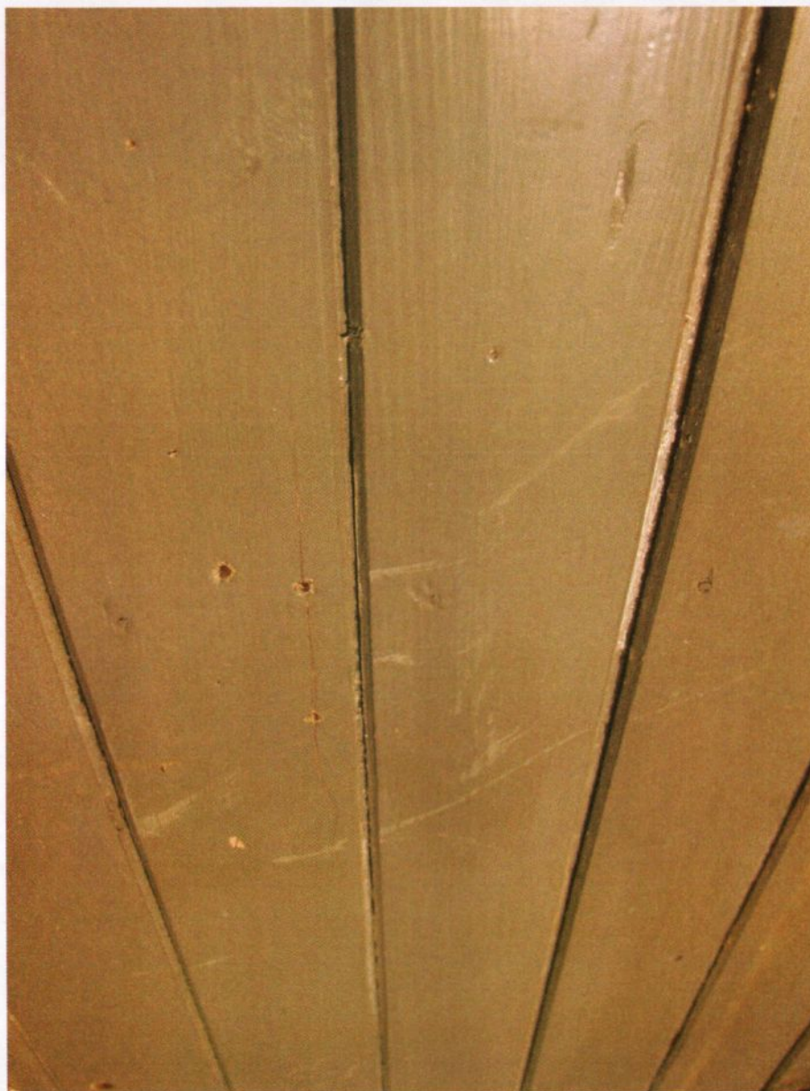
Figur 23. "Amundsenvillaen". Rom 116. Sydvegg. Spikerhull, riss og riper i bunnfargen i nedre del, under luftskipet Norge. Foto. JB. 21.1.2004.
