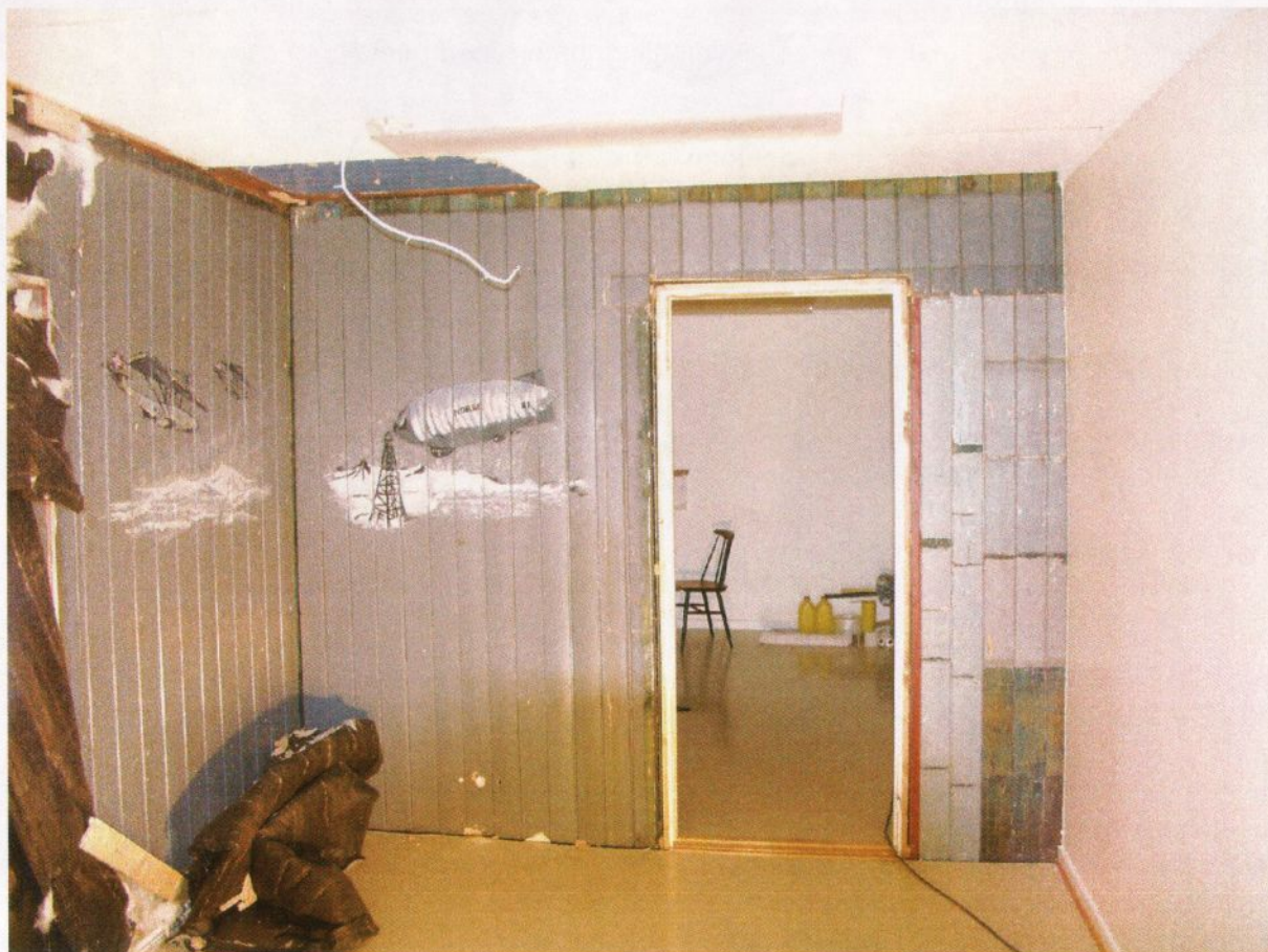
Figur 15. "Amundsenvillaen". Rom 116. Øst del av tidligere Spisestue/Finstue?, sett mot nord. Deler av platekledningen i taket er fjernet. All platekledningen på sydveggen er fjernet. De negative fargesporene viser at det trolig har vært en vanlig hul kil taklist i rommet. I hjørnene har det opprinnelig vært ca. 20 x 20 mm kvartstafflister. Listene har vært malt i veggfargen. De negative fargesporene viser at rom 116 har fortsatt mot vest, og at veggen mellom rommene 116 og 114 er sekundær. Døråpningen mellom rommene 116/114 og rom 115 har vært vesentlig bredere enn dagens åpning, det er heller ikke spor av en dør i denne åpningen. Den malte dekoren er synlig, med N24 og N25 på østveggen og luftskipet Norge på sydveggen. Den nye døra står inntil opprinnelig stender mot øst, men den er høyere enn den opprinnelige døra, og veggen er derfor forhugget over døra. Innkabbingen vest for nåværende dør er utført med materialer fra et annet rom. De negative fargesporene viser at det har stått hyller foran den veggen hvor materialene er tatt fra. Fargene kan tyde på at dette er opprinnelige materialer som er malt opp i 1937. Det kan være materialer fra bakveggen i barinnredningen fra 1937. Foto. JB. 20.1.2004.
