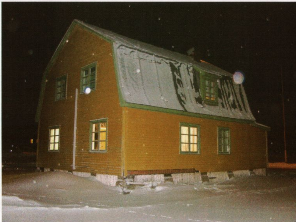
Figur 6. "Amundsenvillaen". Sett fra nordøst. Store endringer i fasaden ødelegger husets opprinnelige preg. De viktigste endringene er det liggende supanet og de nye vinduene. Vinduene står heller ikke i de opprinnelige åpningene. Den opprinnelige hoveddøra mot nord er blendet. Det er i dag kun inngang til huset fra vest. Den opprinnelige pipa er revet. Foto. JB. 20.1.2004.
