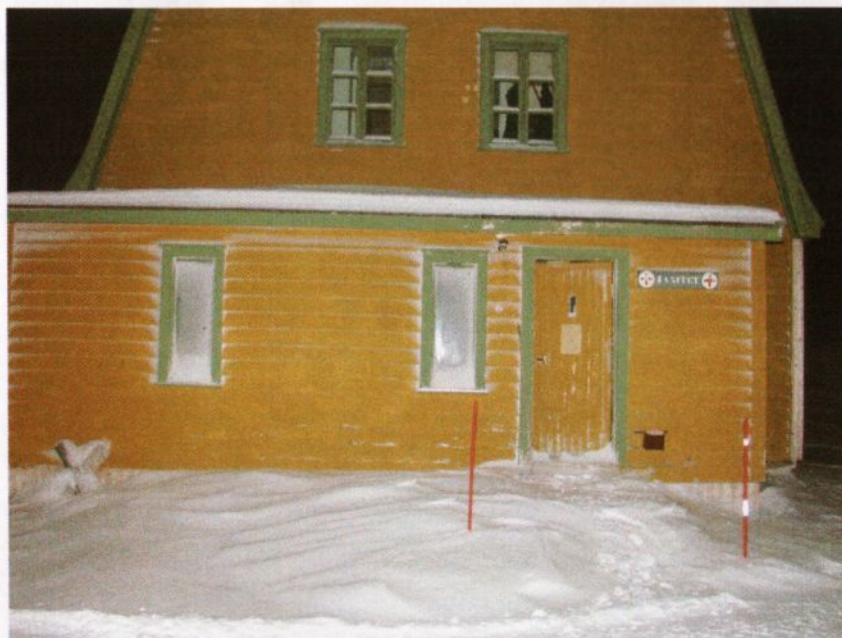
Figur 5. "Amundsenvillaen". Sett fra vest. Store endringer i fasaden ødelegger husets opprinnelige preg. De viktigste endringene er det liggende supanelet og de nye vinduene. Vinduene står heller ikke i de opprinnelige åpningene. Vindfanget er forlenget mot nord. Opprinnelig var vindfanget symmetrisk om inngangsdøra. Nåværende hovedinngangsdør er ny, trolig i 1970 – åra. Foto. JB. 20.1.2004.
