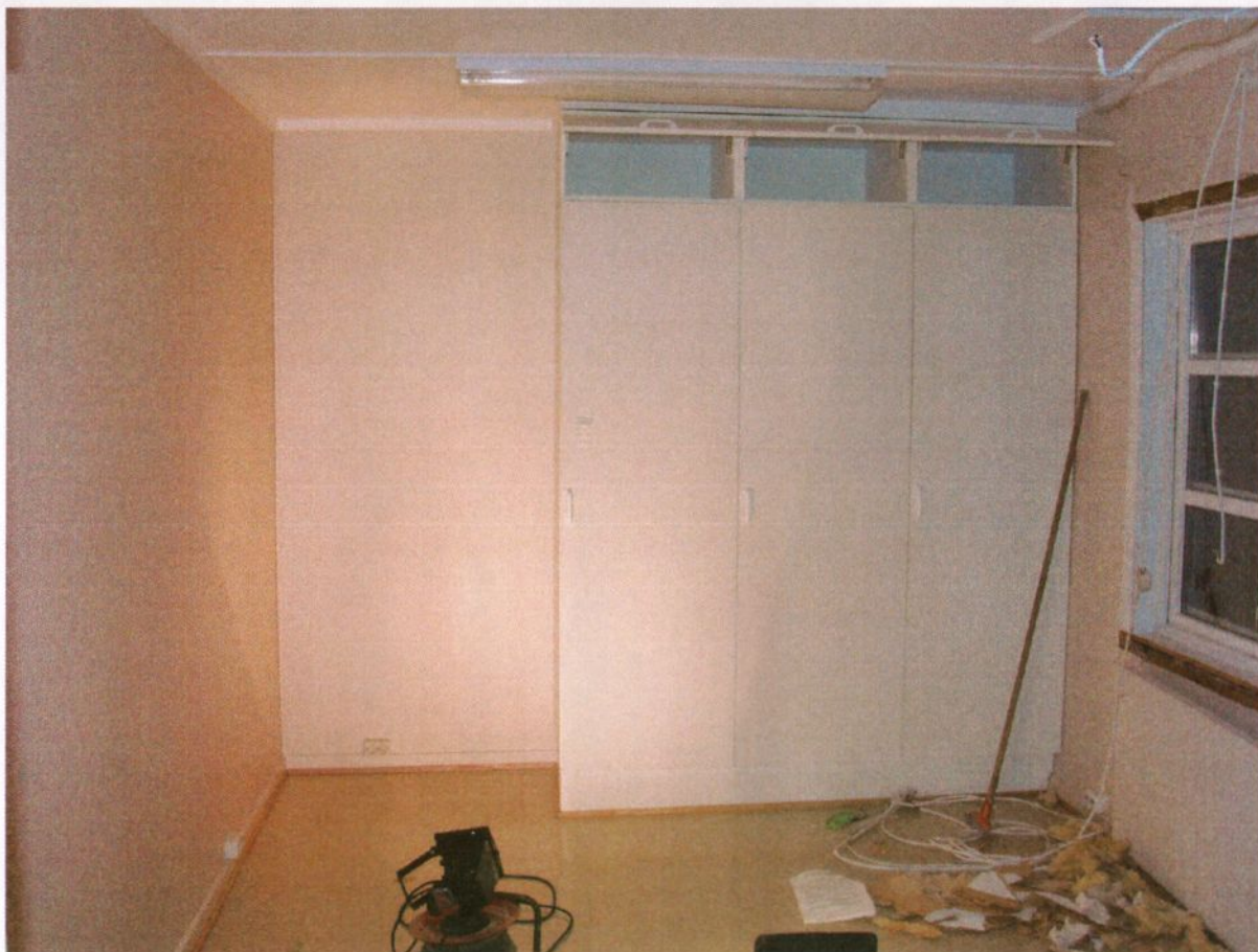
Figur 14. "Amundsenvillaen". Rom 116. Øst del av tidligere Spisestue/Finstue?, sett mot nord. Foto. JB. 20.1.2004.
