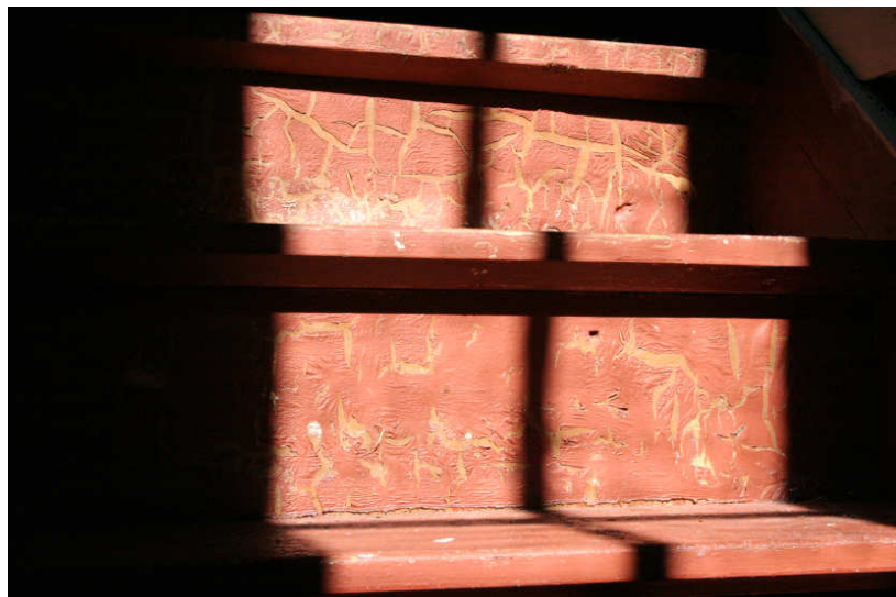
Trappa. Detalj av opptrinnene. Store malingskader på grunn av feil overflatebehandling. Se teksten over.
