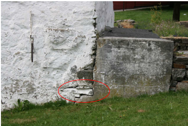
Figur 12 Skader relatert til betongtrapp (sørvegg).
