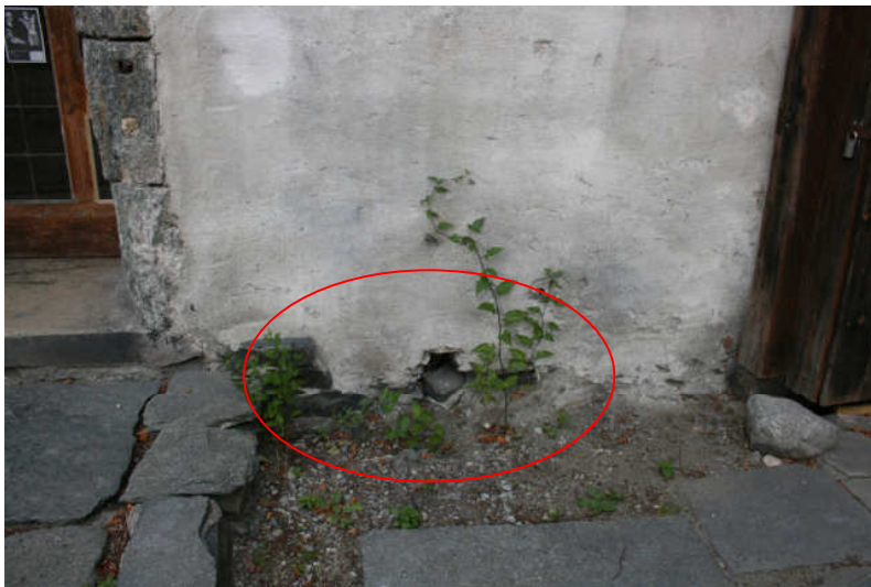
Figur 26 Skade langs bakken, sør for inngangsdør (vestvegg).
