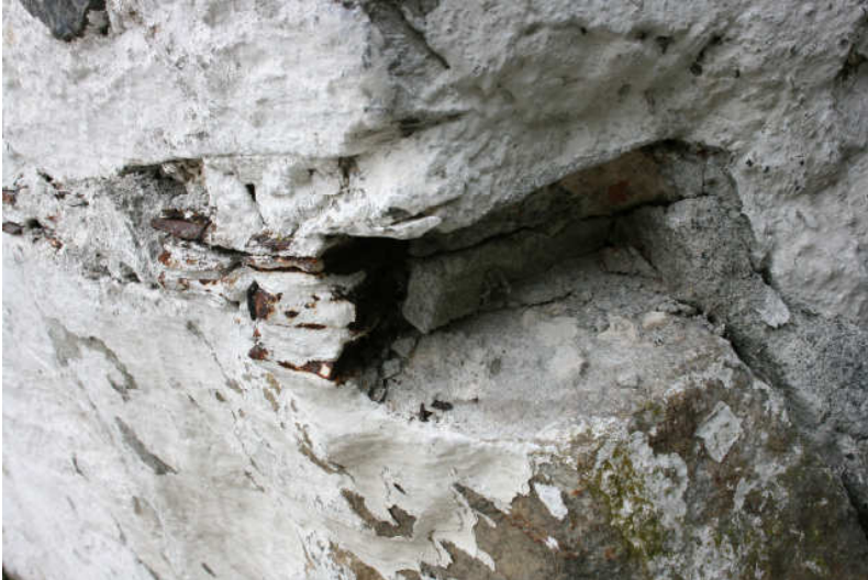
Figur 5 Detalj: rustent jern ekspanderer og kan presse mørtel ut.
