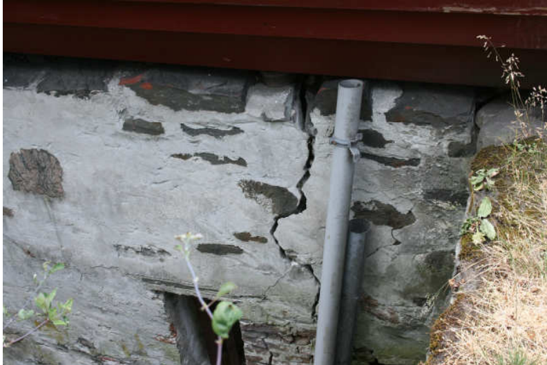
Figur 17 Kraftig revne på østvegg, NØ hjørne.
