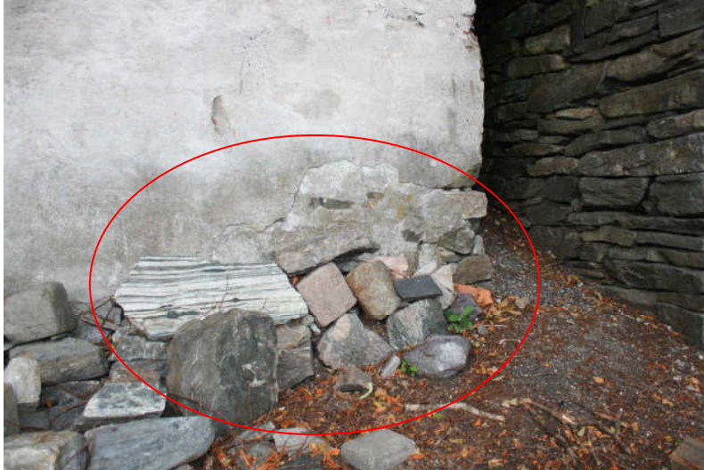
Figur 27 Skader i sørvestre hjørne (vestvegg).
