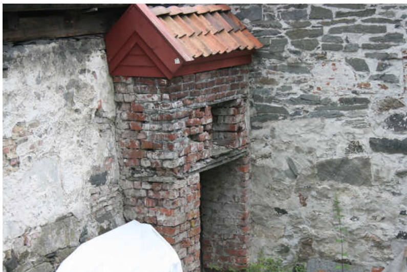
Figur 24 Port i tegl, mye fugeutfall og skader.
