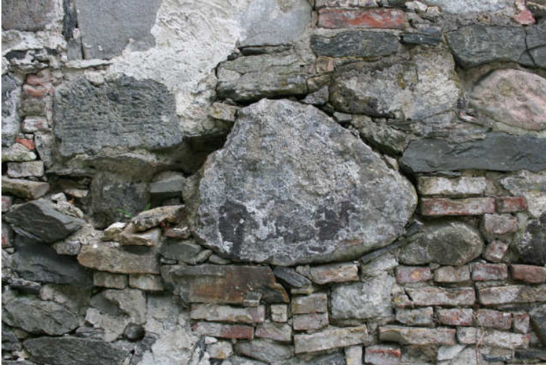
Figur 22 Fugeutfall og løse stener, østvegg.
