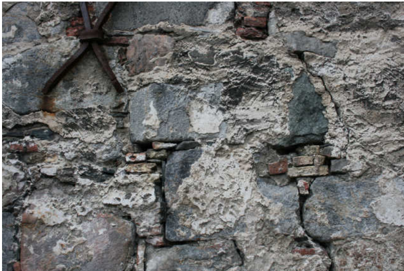
Figur 21 Skader i fuger samt revnedannelse.
