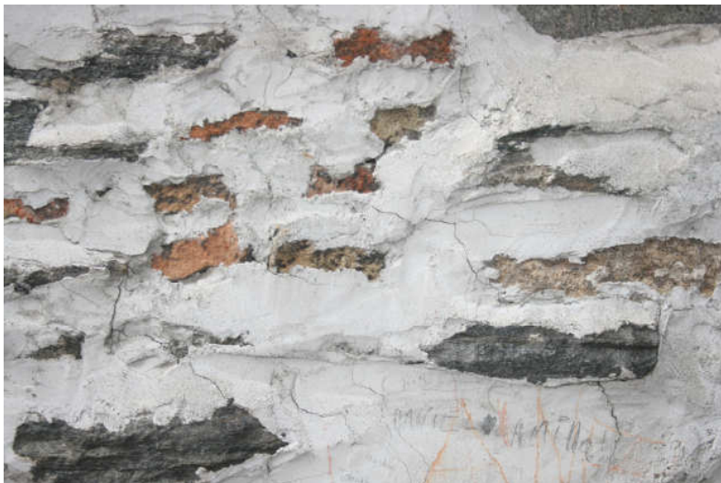
Figur 18 Nyere reparasjon med revnedannelser.
