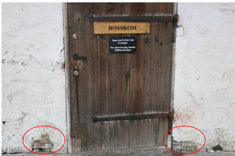
Figur 8 Merk pussutfall på hver side av dør, langs bakken (nordvegg).
