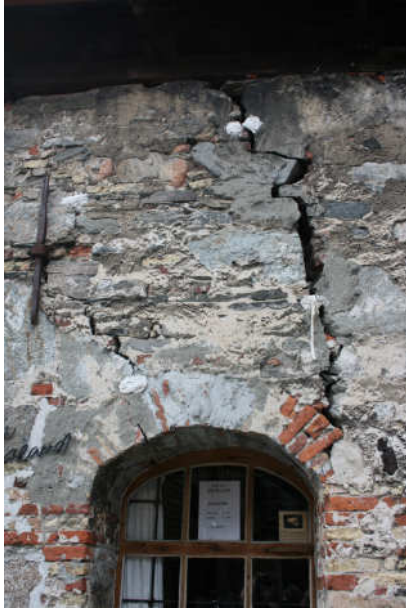
Figur 20 Kraftig revnedannelse over inngangsdør.
