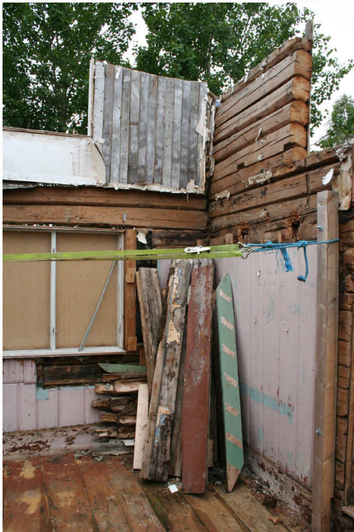
Røros. "Løbør-an", "Sorkenhuset". Panelrester i østrommet 1. etasje. Foto: Brønne. 28.6.2007
