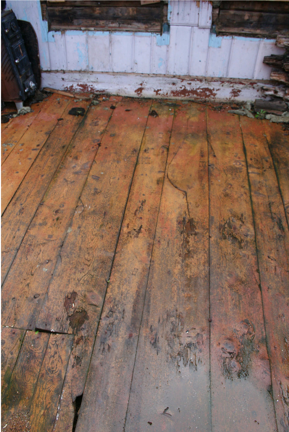
Figur 15. Røros. "Løbør-an", "Sorkenhuset". Rester av et ødelagt eldre gulv i østrommet. Gulvet er sekundært. Foto: Brønne. 13.9.2007.
