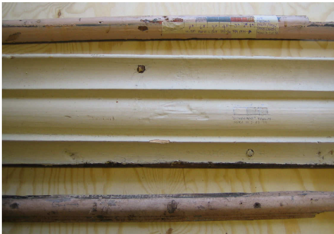
Figur 16. Røros. "Løbør-an", "Sorkenhuset". Listverk. Øverst halvstaffs taklist. I midten en barokk taklist/stussbrett. Nederst en profilert halvstaffs taklist. Foto: Brønne. 13.9.2007.
