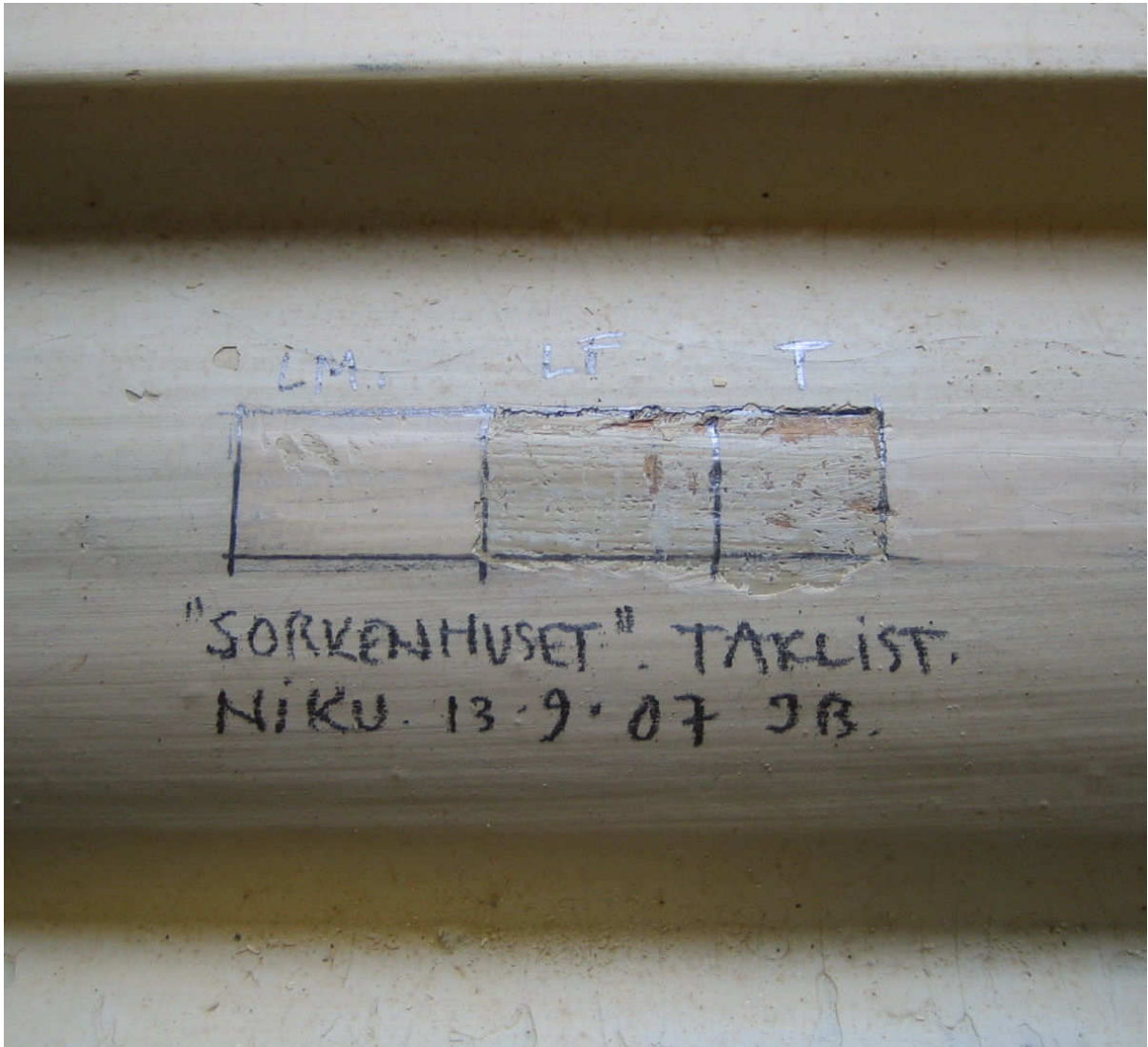
Figur 19. Røros. "Løbør-an", "Sorkenhuset". Fargetrapp på 1700- talls barokk taklist/stussbrett. Til høyre sees treet, som trolig har stått synlig i en periode, og har blitt vasket. I midtfeltet er det mange lag med limfarge, trolig 5-6 lag. Til venstre er det 2-3 lag med linoljemaling. Alle lagene har opprinnelig vært helt hvite Foto: Brønne. 13.9.2007.
