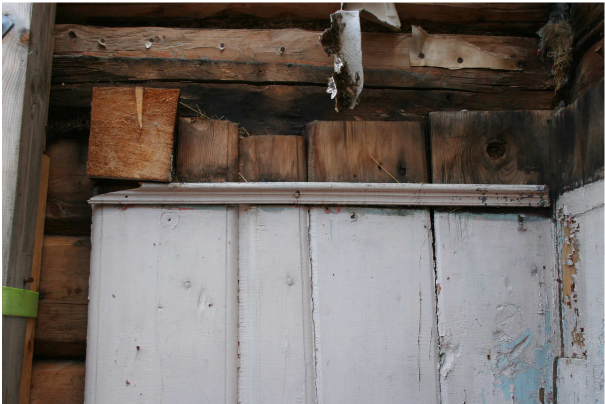
Figur 13. Røros. "Løbør-an", "Sorkenhuset". Bevart eldre panel i østrommet 1. etasje. Nordøsthjørnet, nordveggen. Øverst til venstre sees resten av en forhugget, opprinnelig? takbjelke. Under denne, øverst på panelet står restene av løpelisten som har gått rommet rundt under takbjelkene og stussbrettene. Foto: Brønne. 13.9.2007.
