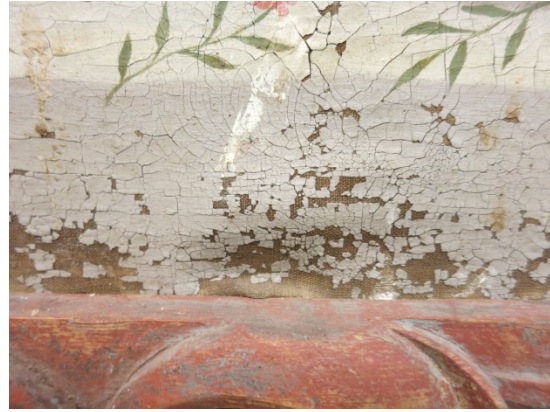
Fig 3: Løs maling, utfall, deformasjon og malingssøl
