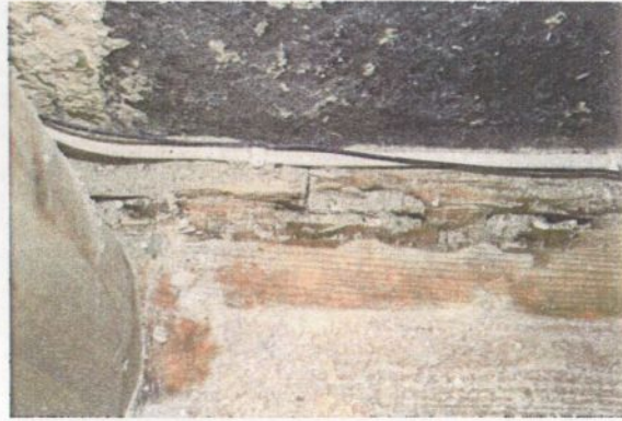
Fig.25 – Råteskader i gulvbord og fuktopptrekk i stolpe til lektoriet i skipets nordøstre hjørne. Foto: Jørgen Solstad 2005
