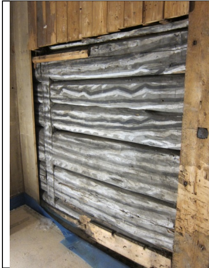
Dekorfeltet under galleriet nedenfor det sentrale vinduet på østveggen viser innsiden av teppet. Undermalingen er lys grå og over har det blitt malt sorte og hvite horisontale striper.
