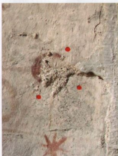
Fig. 3. Pussutfall i saltskadet parti i vindussmyg mot syd
