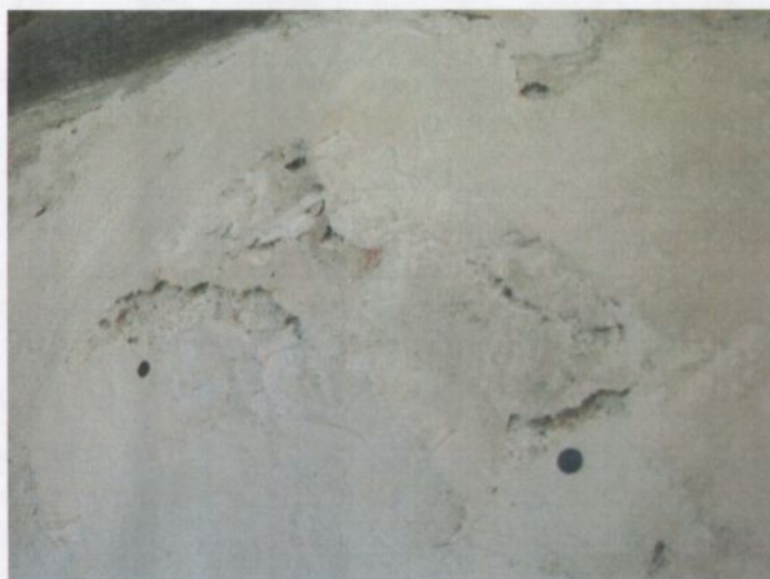
Fig. 4. Pussutfall i saltskadet parti i nedre del av vegg
