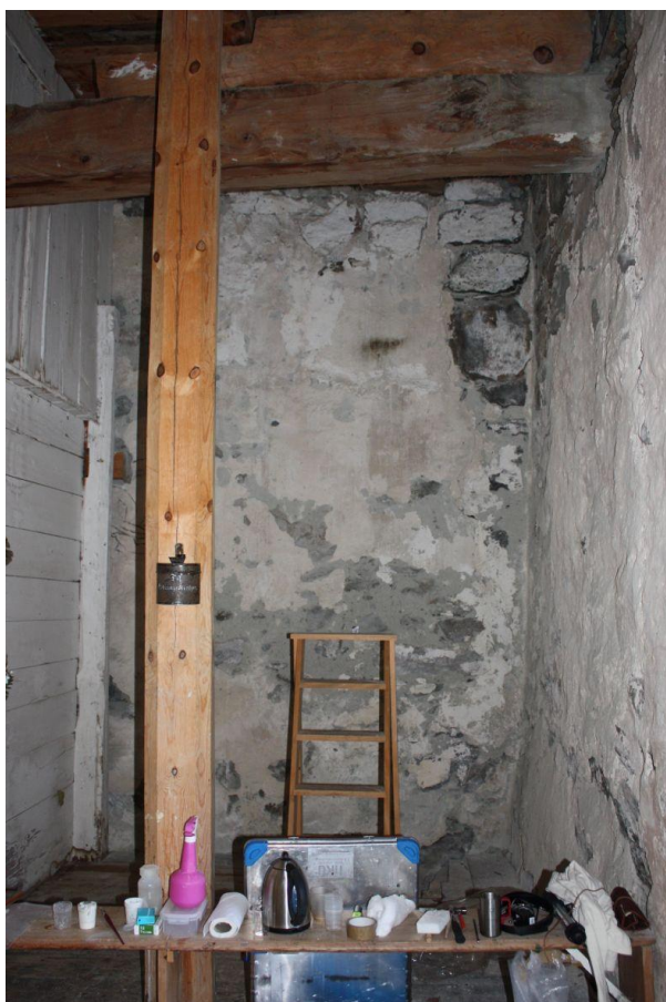
Figur 8. Sydvegg, våpenhus. Området har mye skader i puss uten dekor. 2011
