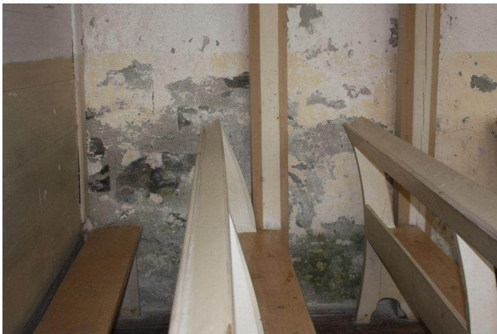
Figur 7. Skadet brystning i området under galleri. Skipets nordvestre hjørne. 2011
