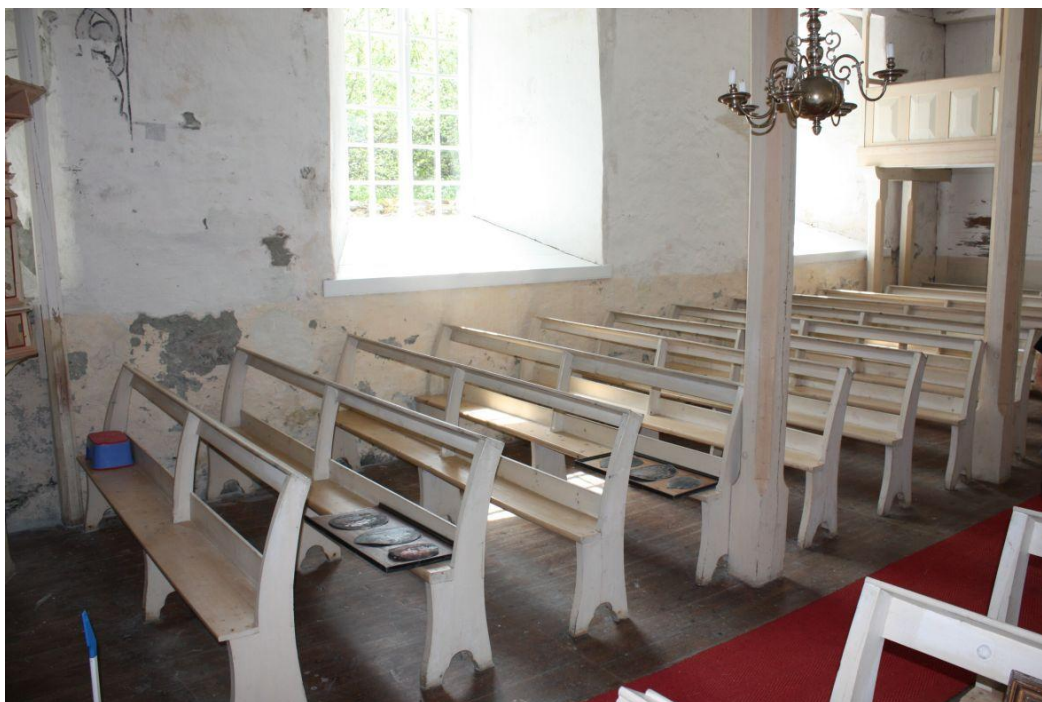
Figur 2. Kirkerommet var preget av forfall ved prosjektstart 2010.
