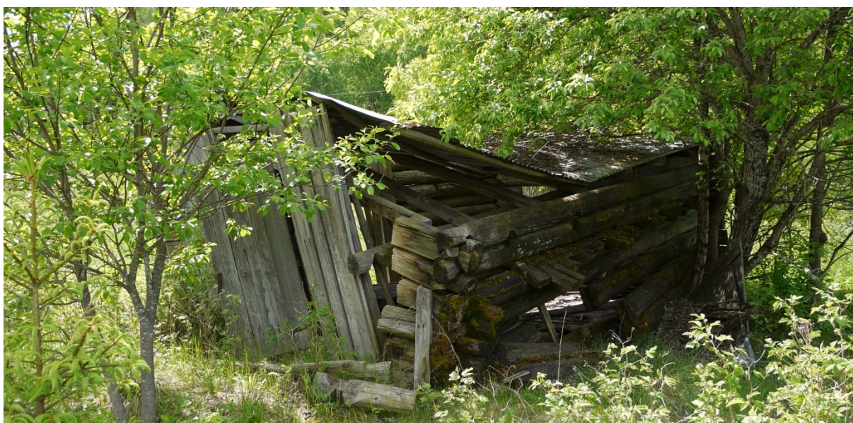
04200017003: Av 30 SEFRAK-bygninger som er registrert som tapt i Eidskog kommune i 3. omdrev, er det 7 som har falt i ruin. Foto ÅD, NIKU 2012.
