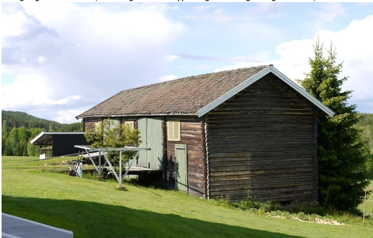
04200006011: Også denne driftsbygningen i Fjell krets er registrert med en liten volumendring, og her er det et mindre tilbygg som er fjernet. På gavlveggen er det tydelige spor etter den tidligere utedoen. Tilsvarende endring er registrert på flere av de eldre uthusbygningene i Eidskog. Foto: ÅD, NIKU 2012.
