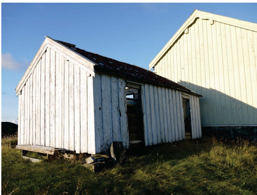
15480015001: Dette stabburet var intakt i 2005, men er registrert som sterkt truet i 2010. Stabburene inngår i bygningskategorien mindre uthus i/nær tunet , som er den av bygningskategoriene som har dårligst tilstand i Fræna i 3. omdrev.
