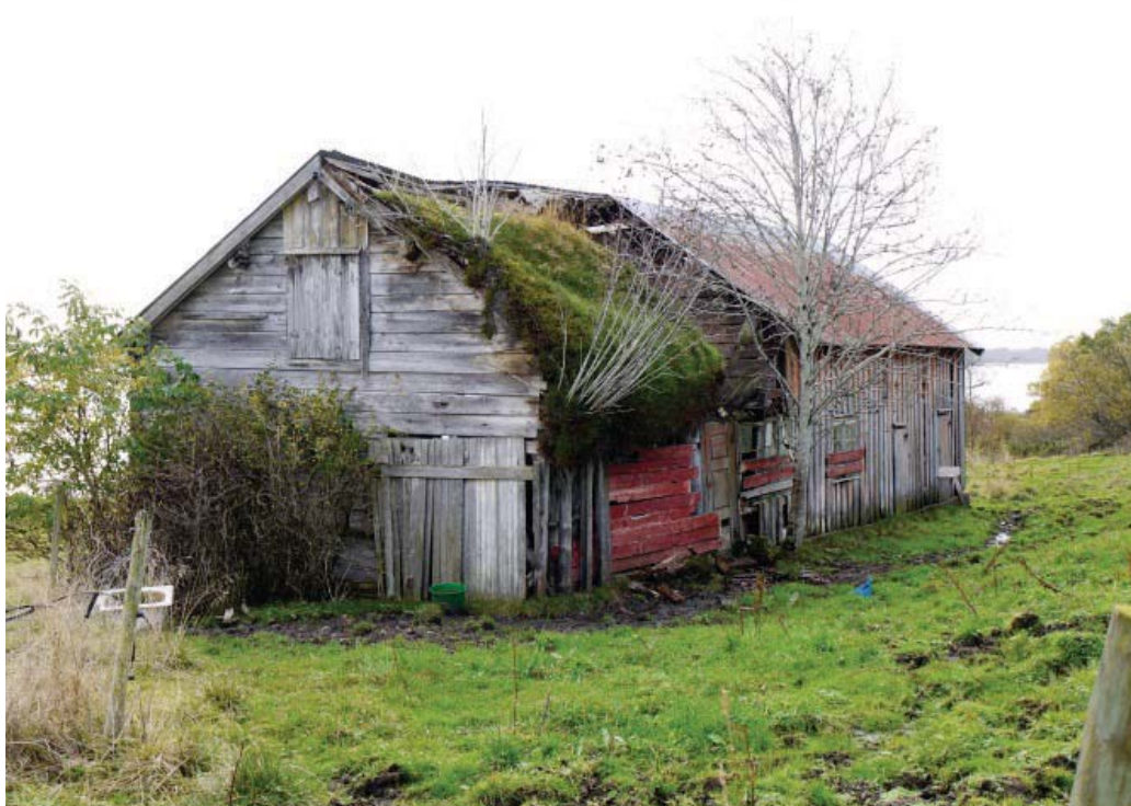
15480003015: I 2010 var forfallet kommet lenger. Den prosentvise andelen av sterkt truede landbruksbygninger er fremdeles dårligere enn gjennomsnittet for Fræna, selv om situasjonen er forbedret i 3. omdrev, med en noe lavere andel sterkt truede bygninger enn tidligere.
