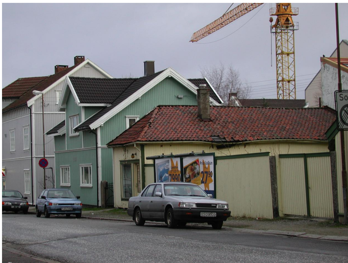
105-203-038. Uthuset i St. Marie gate rommet i sin tid både skomakerverksted, do, skur og sykkelforretning. Nå har det et forfallent preg med dårlig tak. Det var sammenbygd med et lite skur (105-203-039), men dette var revet i 2009.
