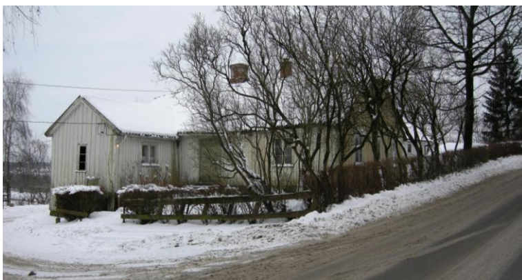
115-101-041. Våningshus i Skjeberg som forfaller. Det er typisk for området med halvvalmet tak og dører med klassisistiske detaljer.
