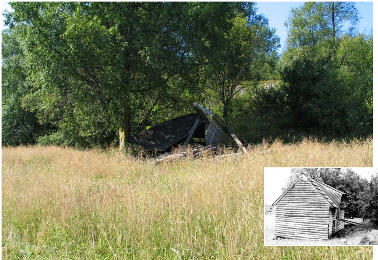
1242-001-055. Utløe som sto i området som nå er del av kommunens friluftsområde på Rolvsvåg, nå falt i ruin.
