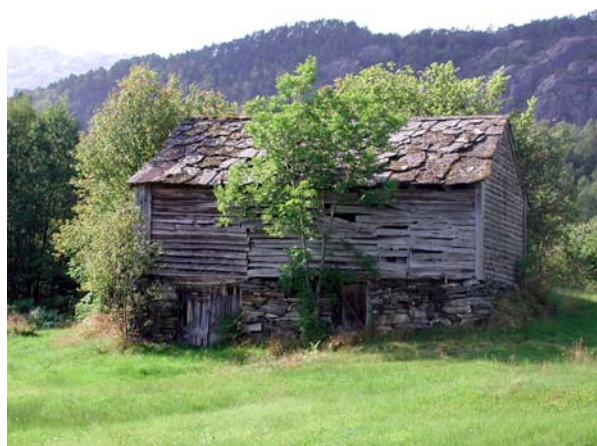
1242-002-114. Driftsbygningen var i dårlig stand ved registrering i 1979, og sto fremdeles på samme måte i 2004. Den er bygd i grindkonstruksjon med fjøs under løa og villskifer på taket.
