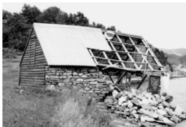
1242-001-085. Naustet på Vågasanden skal iflg. SEFRAK-registreringen ha stått på "glidende sand". Etter hvert sklei det helt ut, og raste til slutt sammen. Det hadde steinvegger og dels plater på taket.
