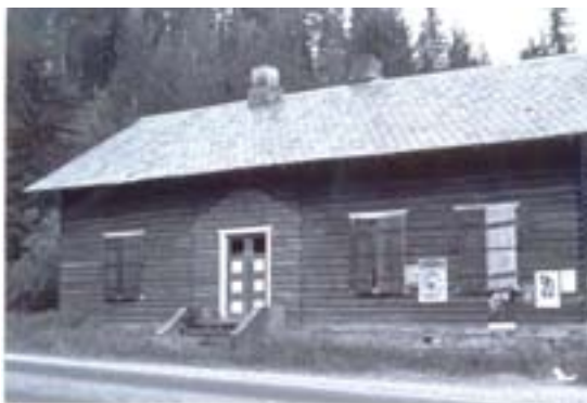
0542-020-001. "Gamle bedehuset" på gården Veggen ved Bjørgo. Huset ble bygd som skole med lærerbolig i 1894, men ble sist brukt som bedehus av Sørskogen Indremisjonsforening. Ved SEFRAK-registreringen sto det ubrukt og var merket av begynnende forfall. Det ble diskutert ulike planer om å flytte huset. Til sist ble det tatt ned, og det skal fortsatt ligge lagret. Skole-sentraliseringen i Nord-Aurdal på 1950- og 1960-tallet førte til at de gamle skolestuene ble stående uten nye funksjoner, og det er i dag svært få som står tilbake.
