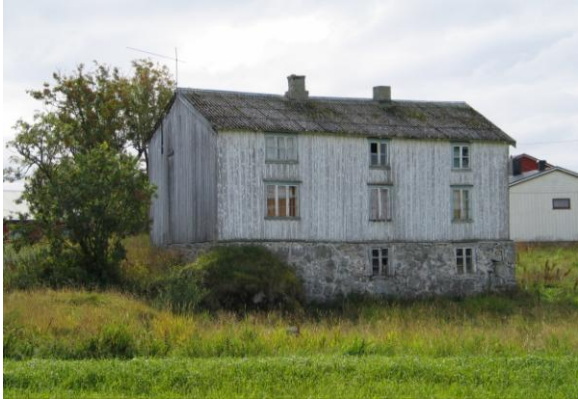
1815-101-008. Våningshus på Ylvingen som har stått tomt siden 1991. Det er blant de eldre husene i kommunen, den eldste delen kan være fra 1700-tallet. Mot slutten av 1800-tallet ble huset utvidet. Taktekket av eternit kom på i 1957, noen vinduer ble skiftet ca. 1970.
