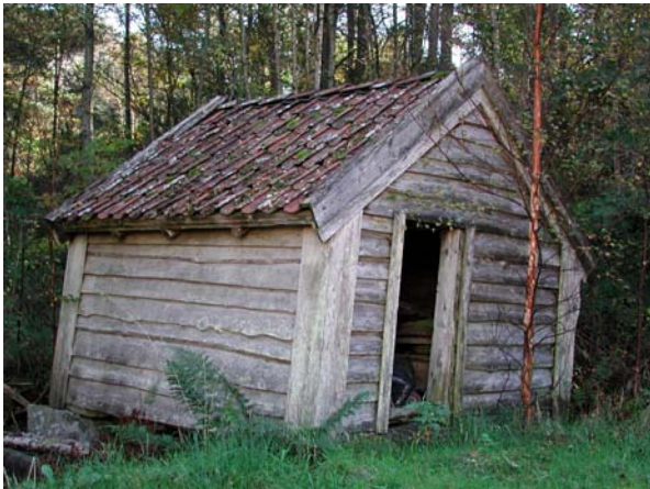
1102-034-017. Kvernhuset på den tidligere plassen Breivik under Bersagel i Høle var preget av begynnende forfall ved registreringen i 1980. Tak og kledning er siden utbedret, men fundamentet er i dag i ferd med å svikte. Nå hører ikke kvernhusene til de mest truede i Sandnes, lokal dugnad er lettere å mobilisere for denne hustypen, og flere er blitt lagt under Sandnesmuseets vern.
