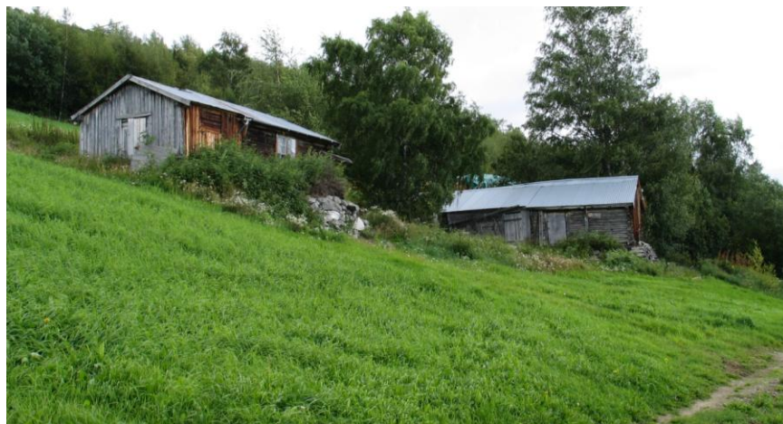
De to stuebygningene på husmannsplassen Blikka var i svært dårlig forfatning ved registreringen i 1980. I 2002 var det lagt nye platetak og ryddet opp, men husene siger og vinduer er fortsatt dårlige. Husmannsplassene har en relativt sett større andel av dårlige våningshus. (0513-003-005, 006)
