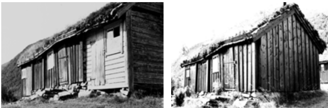
1548-009-041. Seterbua på Malmesetra ble på begynnelsen av 1900-tallet påbygd mot øst og vest. Ved SEFRAK-registreringen var den i noe dårlig stand. Den er siden satt i stand ved midler fra STILK. Da ble tilbygget mot øst revet, og kledning og takbelegg ble fornyet. På grunn av at bua er forkortet er endringen klassifisert som endringstype B.
